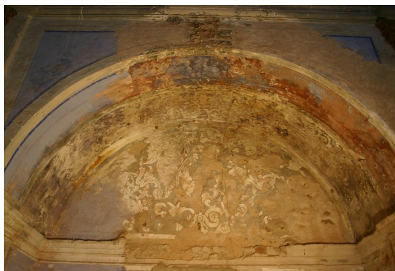
Figura 84. Pérdida de película pictórica, separación de estratos y pérdida de estos
