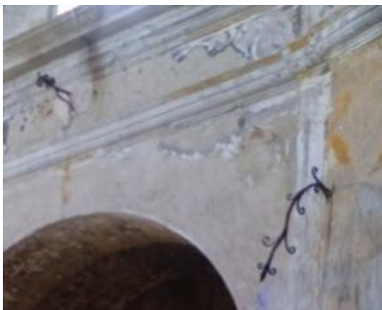
Figura 53. Soportes metálicos de antigua iluminación
