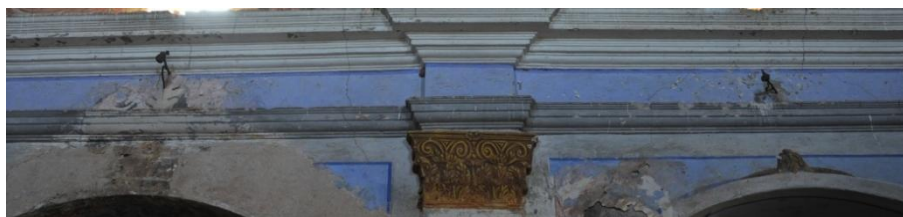
Figura 52. Grietas en cornisa y sobre arcos de medio punto.
