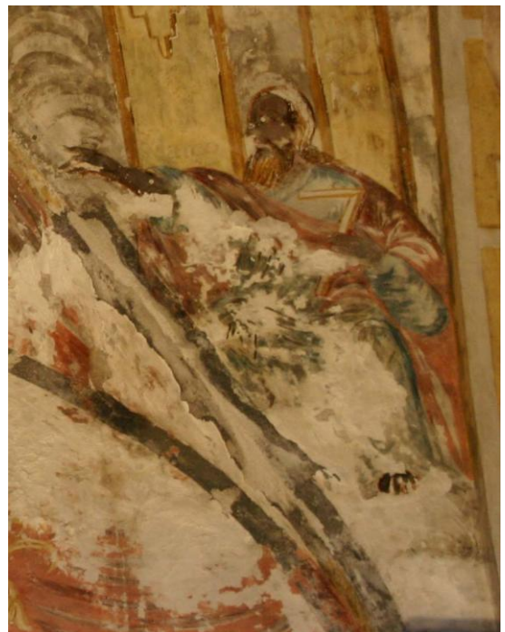
Figura 43. Desprendimiento de capa pictórica y estuco
