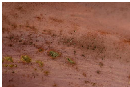
Figura 24. Manchas de humedad
