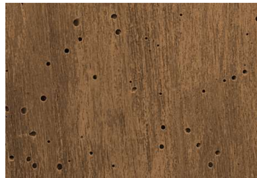
Figura 40. Daños más graves encontrados producidos en una viga de la vivienda por esta termita.
