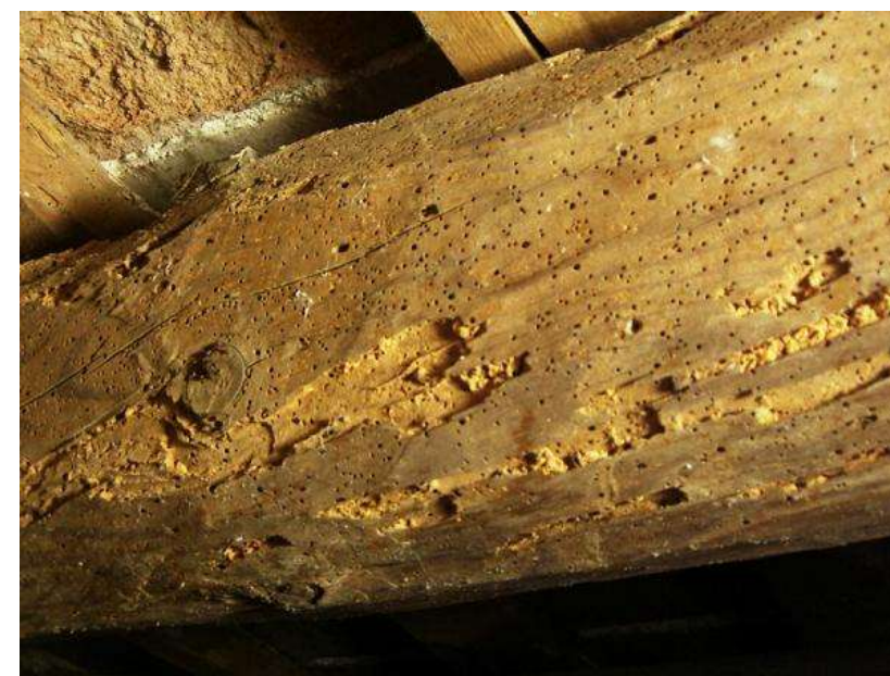
Figura 39. Daños graves producidos por xilófagos en una viga que no pertenece a la vivienda.
