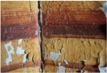
Fotografía 29. Escamas en la pintura.
