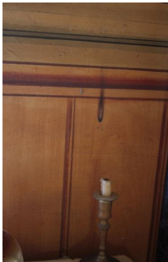
Fotografía 38. Detalle de la quemadura en las pinturas.
