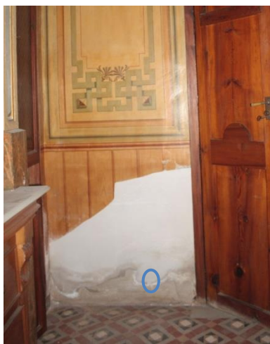
Fotografía 41. Pared Sur con las sales y el punto de recogida de las muestras.
