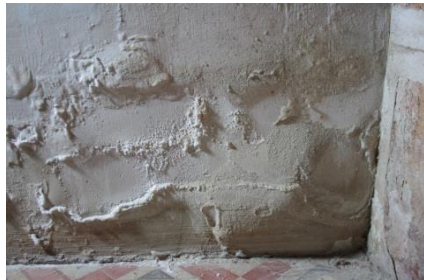
Fotografía 28. Abolsamientos del muro.
