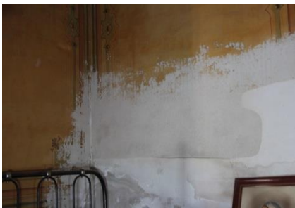
Fotografía 36. Falta de pintura.
