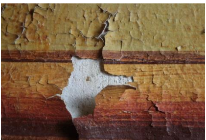
Fotografía 31. Craqueladuras y levantamiento de la pintura original.
