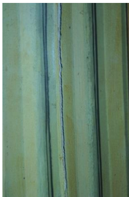
Fotografía 32. Detalle de grieta.
