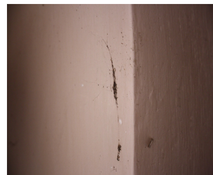
Figura 40. Detalle de suciedad superficial acumulada en la esquina de los muros sur-oeste.
