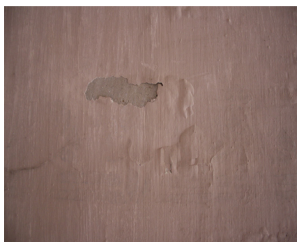
Figura 46. Detalle de una zona con pérdidas en el muro norte.
