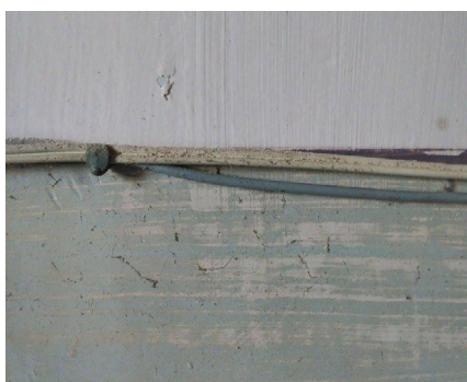
Figura 42. Detalle de suciedad superficial localizada en el zocalo de la pared este.
