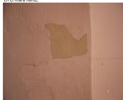
Figura 49. Detalle de otra zona, en la que se pueden ver diferentes estratos de colores, localizada en el muro norte.
