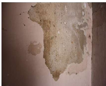
Figura 45. Detalle de una zona con pérdidas en el muro oeste.
