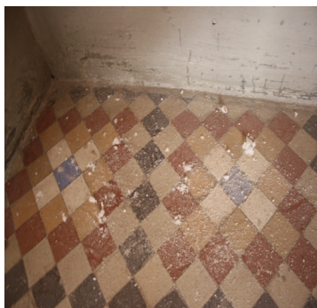
Figura 63. Detalle de los restos de sales del techo encontradas en el suelo.
