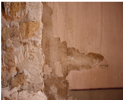
Figura 50. Detalle de pérdidas y otras intervenciones en el muro orientado al norte.
