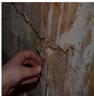
Figura 57. Detalle de la recogida de las muestras de sales de la parte inferior del muro orientado al norte.
