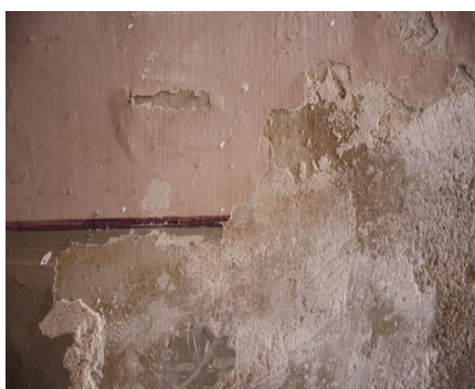
Figura 33. Detalle de zona con pérdidas de película pictórica.
