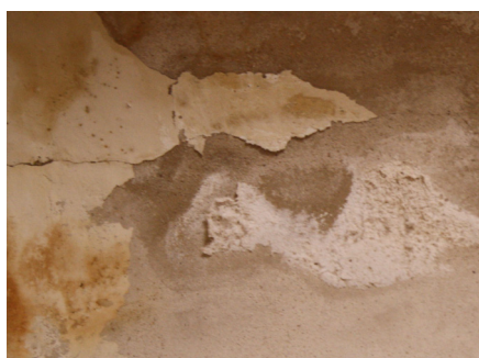
Figura 56. Detalle de humedades y sales presentes en el techo.
