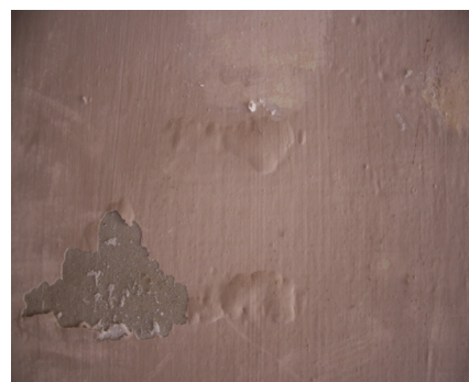
Figura 47. Detalle de una zona con pérdidas y abolsamientos en el muro norte.
