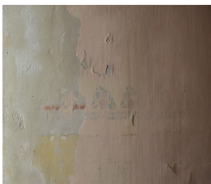
Figura 32. Detalle de zona con encalado y pérdidas.
