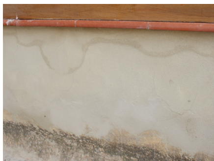
Figura 54. Detalle de humedades y otras intervenciones en el muro orientado al norte: vista desde el exterior.
