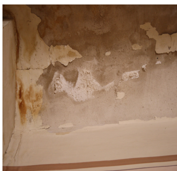
Figura 64. Detalle de las sales encontradas en el techo.
