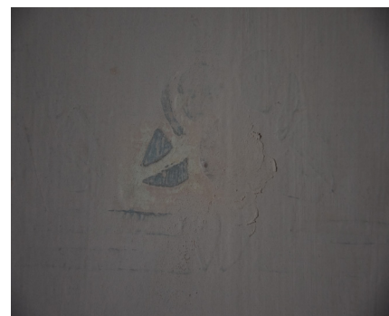
Figura 31. Detalle de zona encalada con pintura descubierta.
