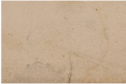
Imagen 30. Manchas de humedad.
