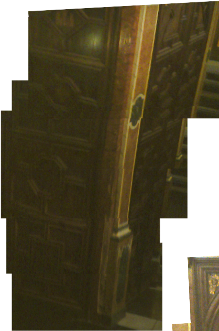
Fig.38 Fotomuntatge que mostra gran part d'una de les columnes frontals i el seu deteriorament.
