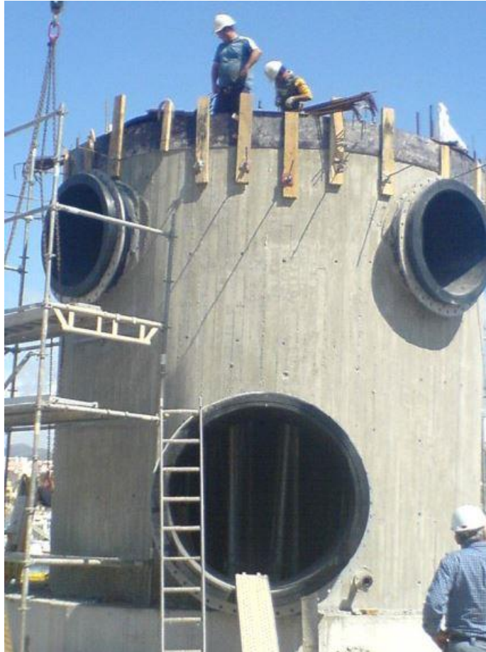
Figura 3: Torre de toma (fuente www.desalchile.cl )
