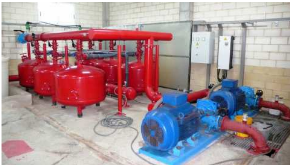
Bombas de inyección y filtros.
