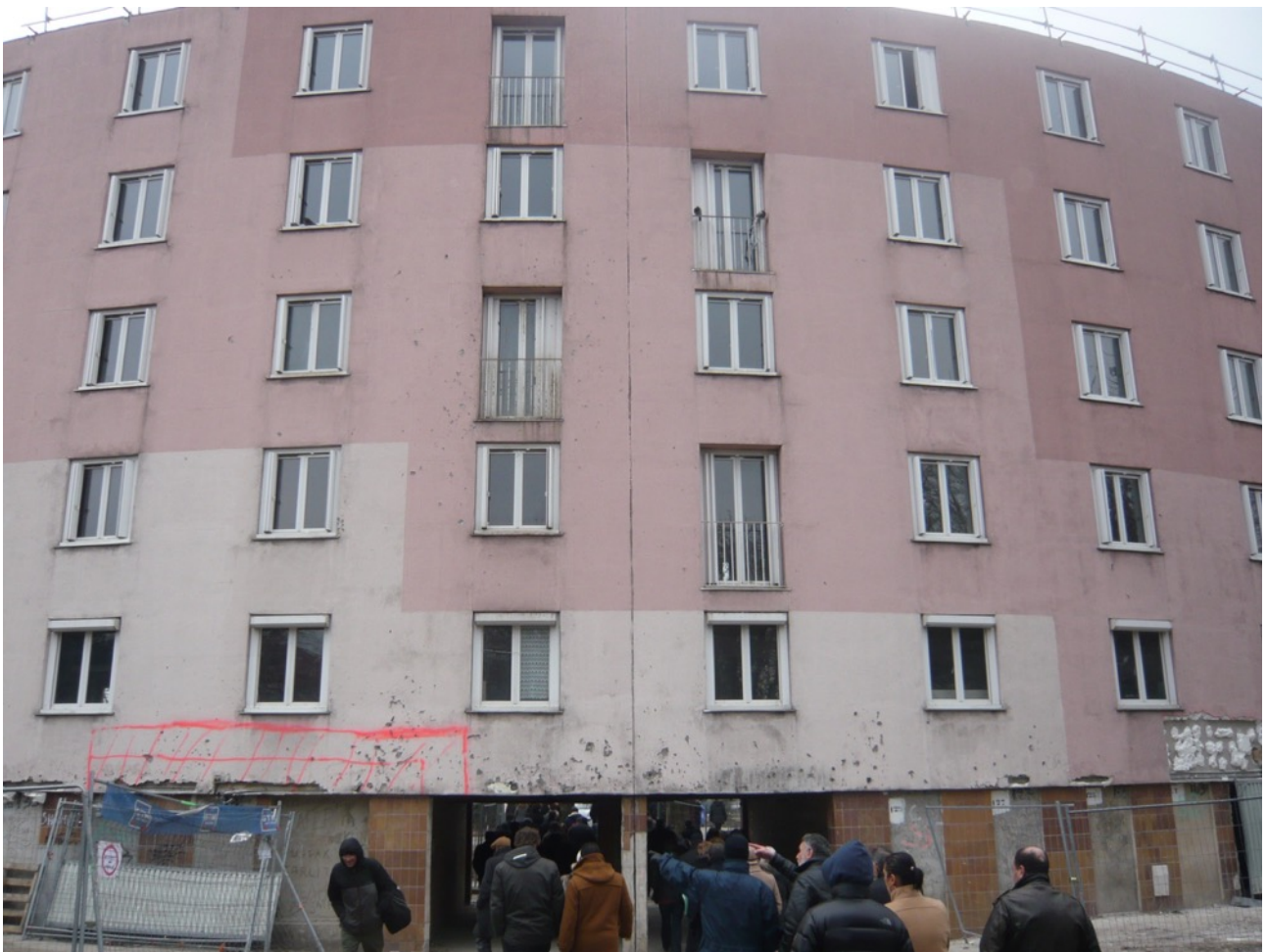
Figura 13. Imagen que muestra la degradación del edificio de Le Serpentin
