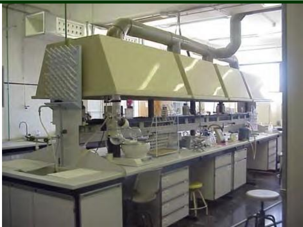
Batería de campanas de extracción sobre banco de laboratorio
