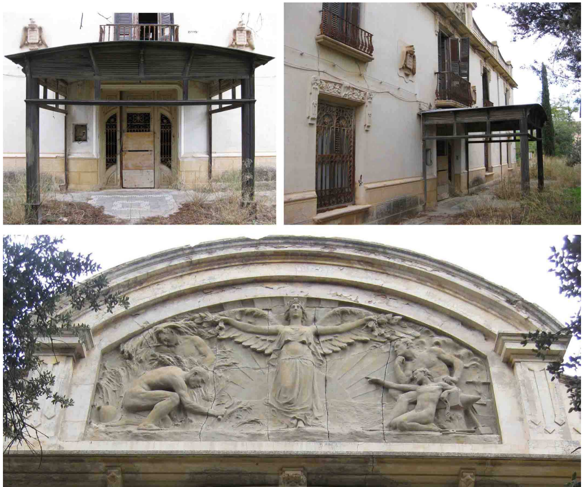
Fig.5.2.4.12. Estado actual del acceso principal y del relieve en el antepecho de cubierta, con la alegoría femenina. Imágenes de la autora de octubre de 2012.
