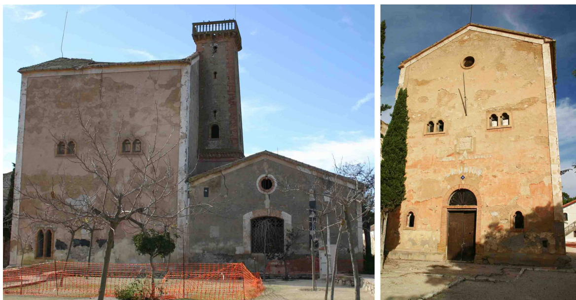
Fig.5.2.5.7. En la imagen de la izquierda, la alcoholera, la bodega y la torre en su estado actual. Se puede ver el estado de la cubierta, tras su desplome parcial en 2010 (fotografía de la autora en diciembre de 2011). En la derecha, fachada Sureste de la alcoholera, con la puerta de acceso, la inscripción y el reloj de Sol (imagen de la autora de octubre de 2012).
