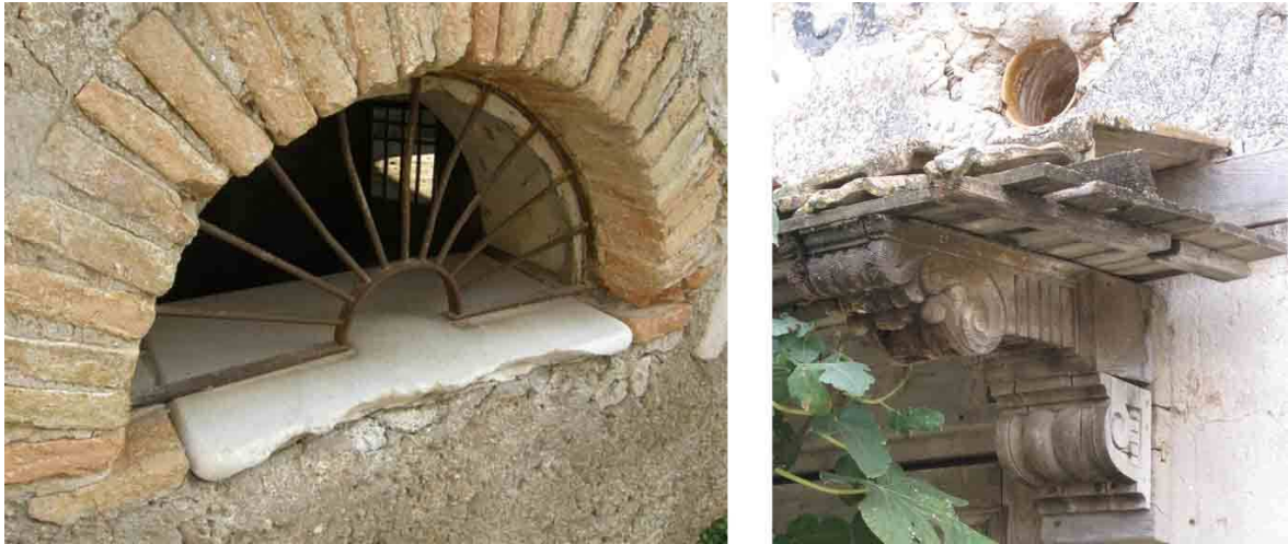
Fig.5.2.8.4. Detalles de la taquilla (< www.coloniasantaeulalia.com >) y de la ménsula de la marquesina en la puerta de acceso de enfrente de la almazara (imagen de la autora en octubre de 2012).
