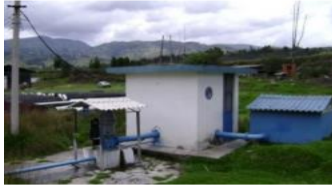
Fig 8. Captación de los pozos subterráneos (Llio).
