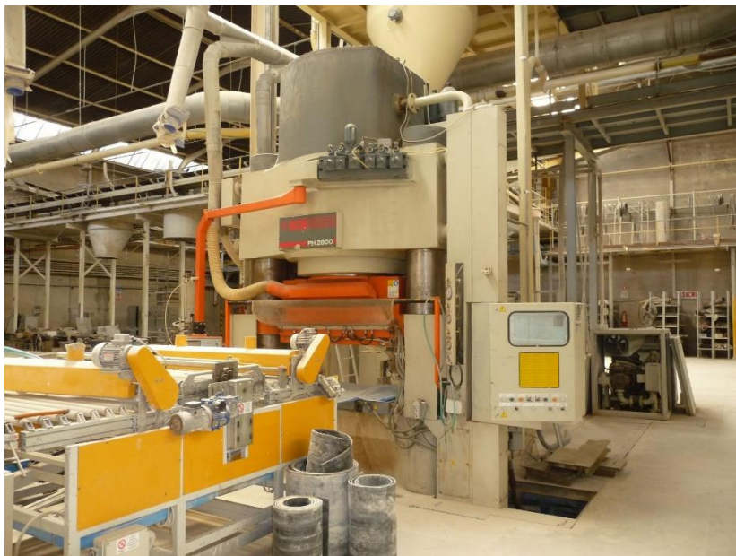
Figura 3.4 Prensa hidráulica utilizada en la línea de producción.
