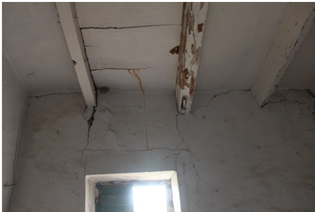
Fotografía 18. Grietas varias. 2016. Fuentes propias
