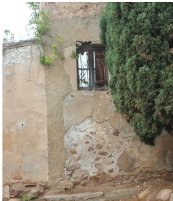
Fotografía 30. Mezcla de revestimientos. 2016. Fuentes propias
