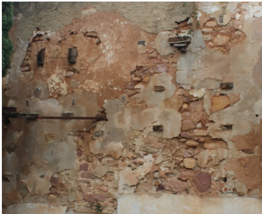
Fotografía 32. Mezcla y falta de revestimientos. 2016. Fuentes propias
