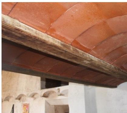
Fotografía 31. Ausencia de revestimiento. 2016. Fuentes propias
