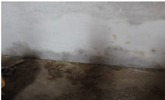
Fotografía 28. Humedades. 2016. Fuentes propias
