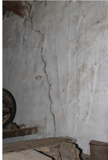
Fotografía 17. Grieta en muro. 2016. Fuentes propias
