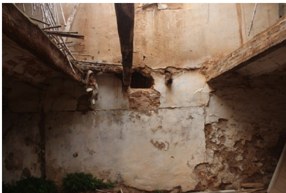
Fotografía 24. Forjado colapsado. 2016. Fuentes propias
