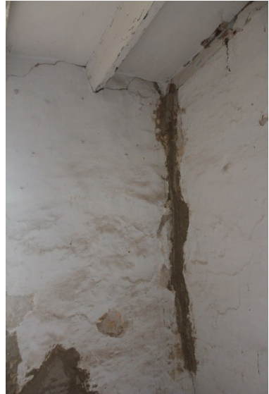
Fotografía 19. Grieta interior junta muro. 2016. Fuentes propias
