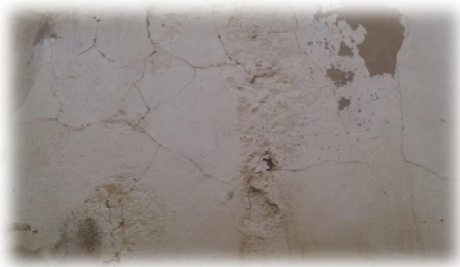
Detalle de fisuración en fachada
