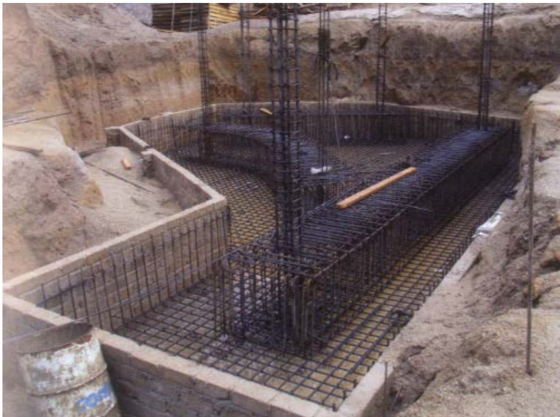
Imagen 37. Imágenes sobre la construcción de la cimentación de los núcleos). Documentos de Arquitectura nº 60. Revista del Colegio de Arquitectos de Almería.
