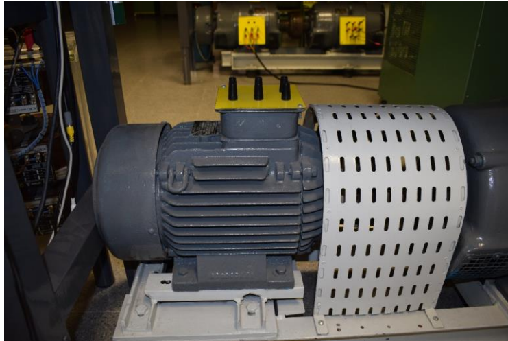
FIGURA 48. Motor trifásico asíncrono General Electric FM132MX/4
