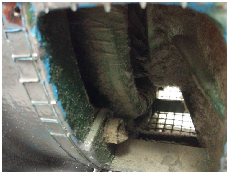
FIGURA 58. Inspección del estado interno interna del motor 11381
