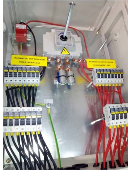
Figura 3.15: Detalle de las protecciones de la caja de concentración de series Fuente: Instalaciones Innergy,2016
