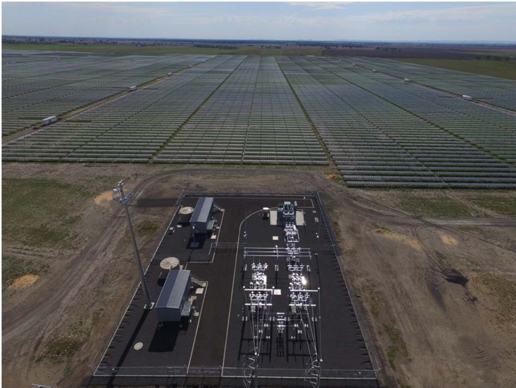
Figura 3.20: Ejemplo de subestación. Consistida por celdas, transformador y línea aérea. Fuente: Moree Solar Farm. Archivo Elecnor 2015.
