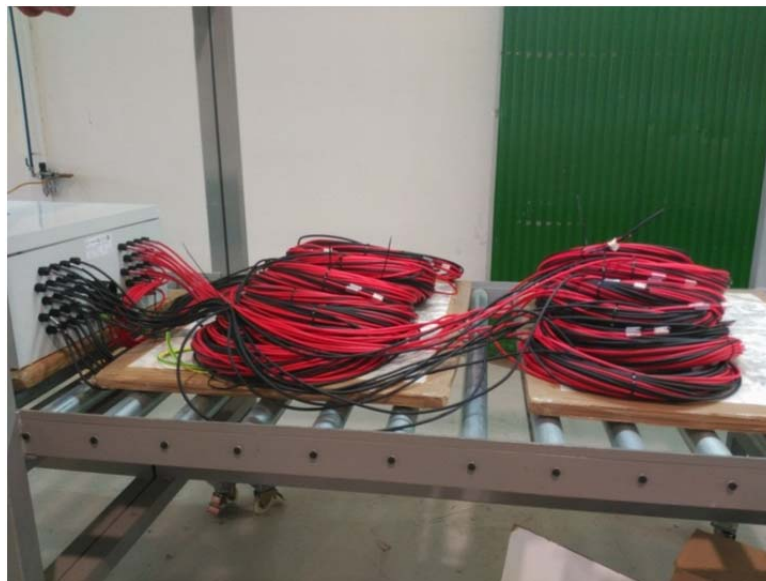
Figura 3.16: Detalle del cableado pre ensamblado en fábrica Fuente: Instalaciones Innergy,2016
