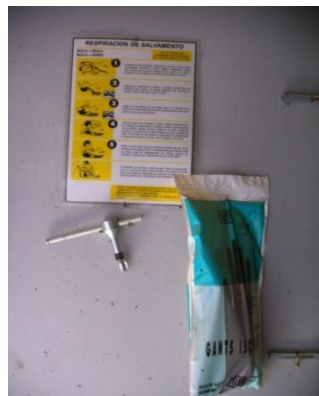
Elementos para maniobra y placa de riesgos
