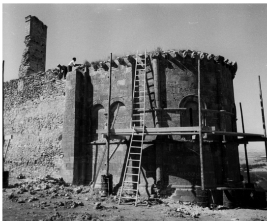
Fig. 3.43. Inicio de los trabajos de apertura de un paso entre el ábside y el muro de la nave, que permitiría el acceso de cimbras al interior. The Cloisters Archive
