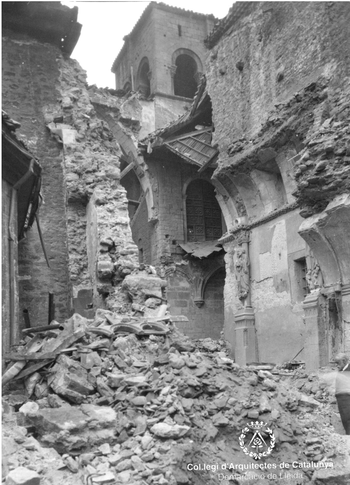
Fig. 3.18. Estado de la Cámara Santa de la Catedral de Oviedo tras la voladura. CAC Demarcació de Lleida
