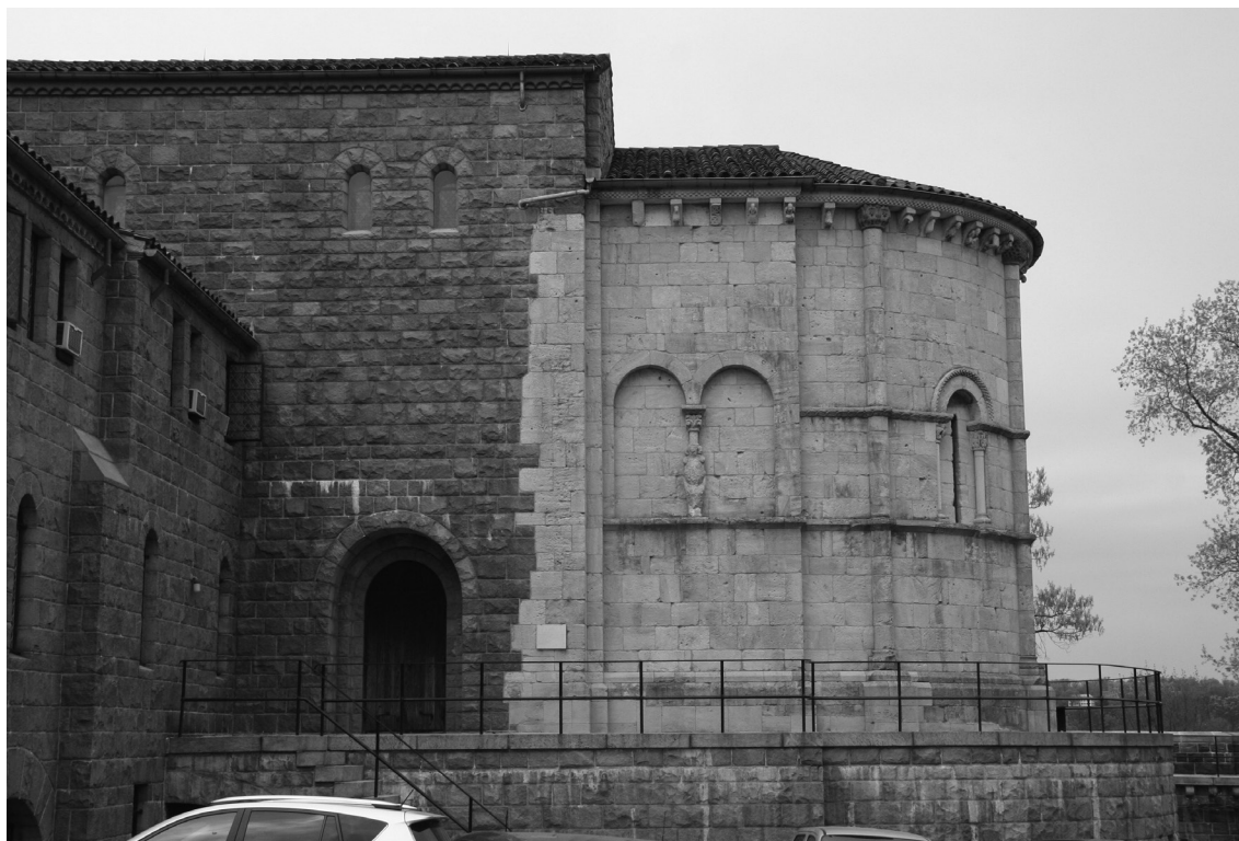
Fig. 4.4. Vista del alzado sur del ábside en The Cloisters, donde se aprecia la tonalidad distinta del material pétreo con respecto a la obra nueva y la inclusión de un canalón de recogida de aguas
