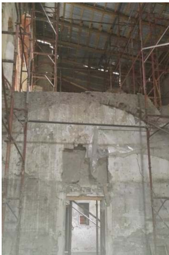
Danno causato agli elementi vicini.
