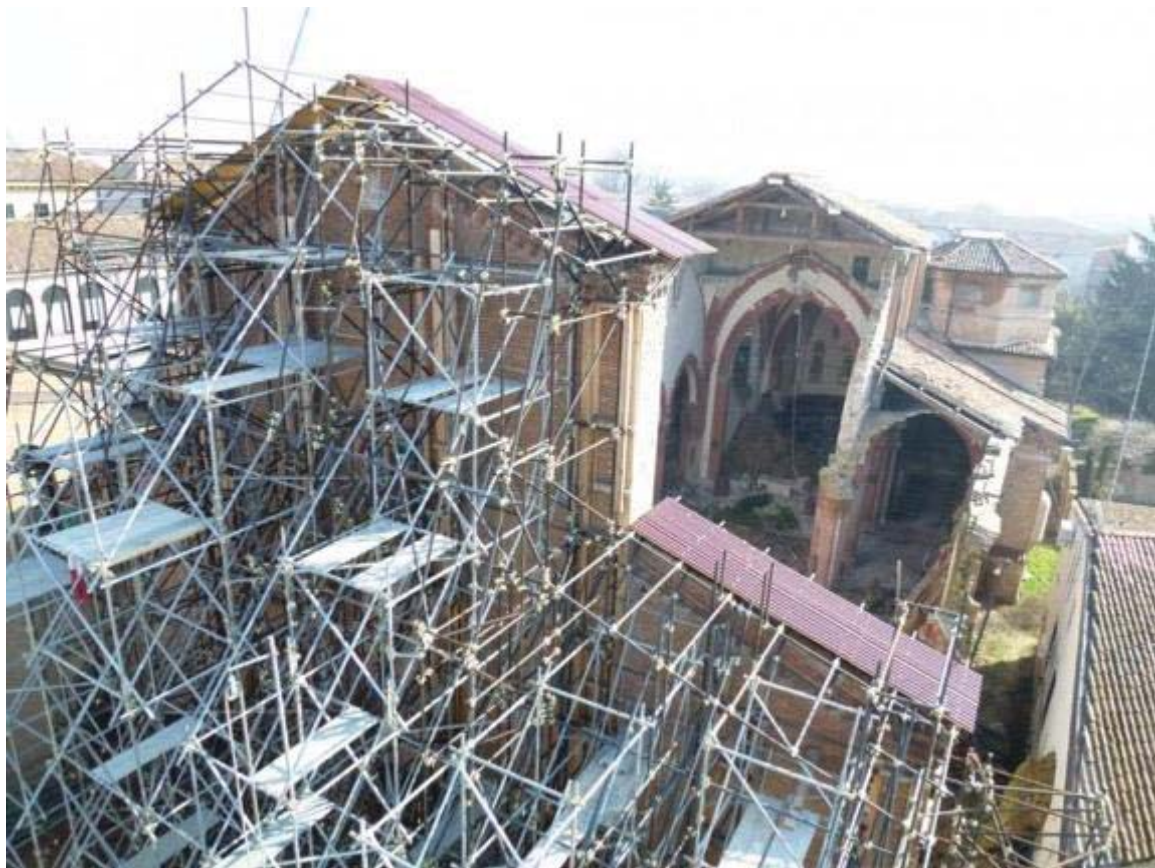
Chiesa di San Francesco dopo il terremoto
