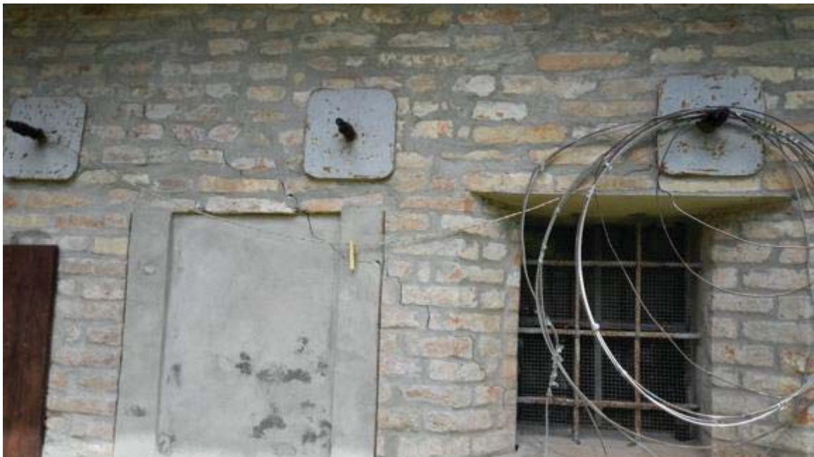
Fessura per trazioni del muro.
