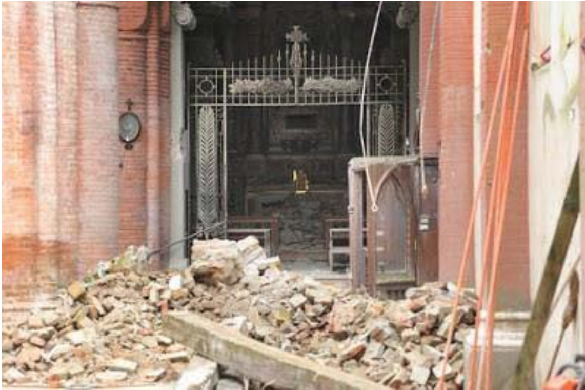
Chiesa di San Francesco dopo il terremoto
