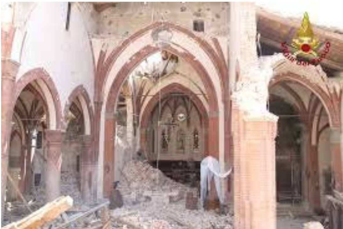
Interno chiesa di San Francesco dopo il terremoto
