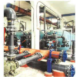
Bombeo y filtrado
