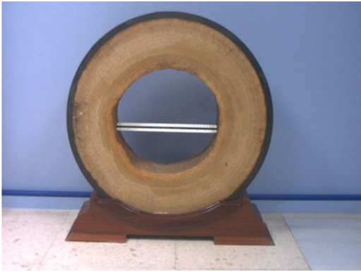
Figura 14 Tubería muy envejecida tras décadas de servicio
