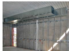
Conductos de aire acondicionado
