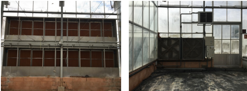
Fotografías 2.2. y 2.3. “Cooling system” y calefacción
