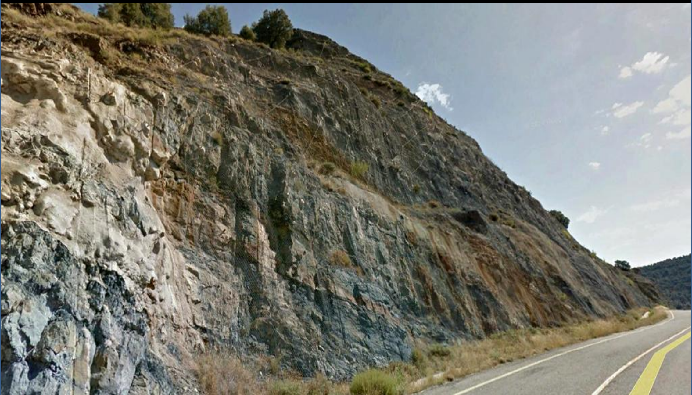
Actuaciones- mallazos, bulones, gunitado- para la estabilización del talud en los materiales alternantes pelítico- samíticos, del Valanginiense, Cretácico Inf. NE de Yanguas, Soria. NE Hoja de Enciso.
