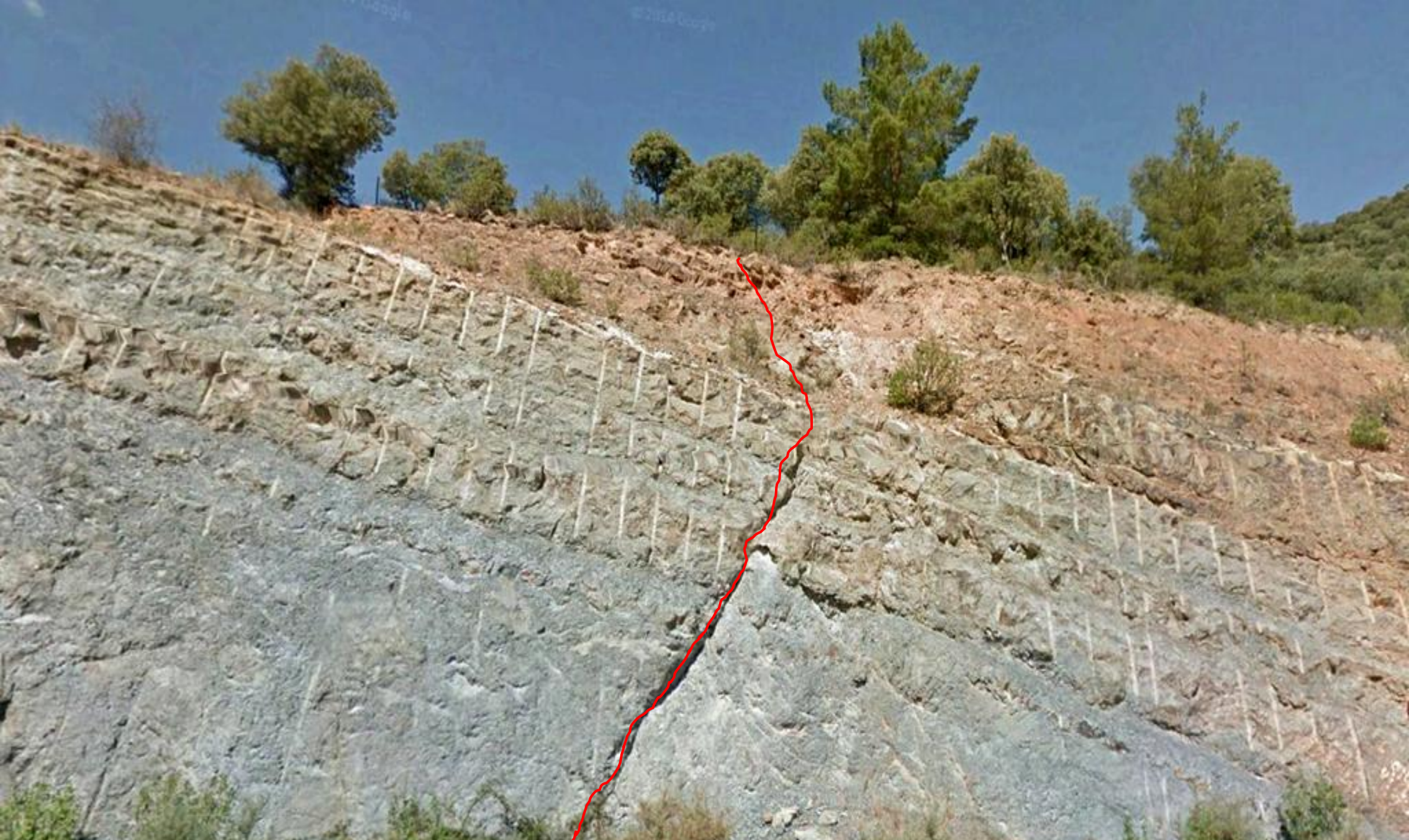
Detalle en la anterior; falla normal en serie alternante pelítico- samítica, del Valanginiense, Cretácico Inf. NE de Yanguas, Soria. NE Hoja de Enciso.
