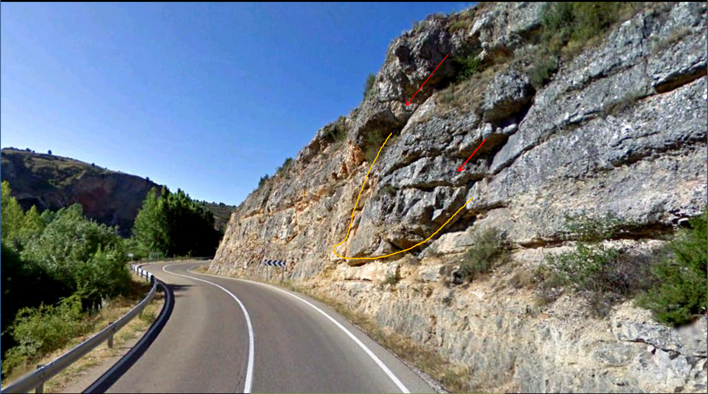
Peligrosidad en talud de calizas del Coniaciense, Cretácico Sup. N de Ucero, Soria. Centro SW Hoja de San Leonardo de Yagüe
