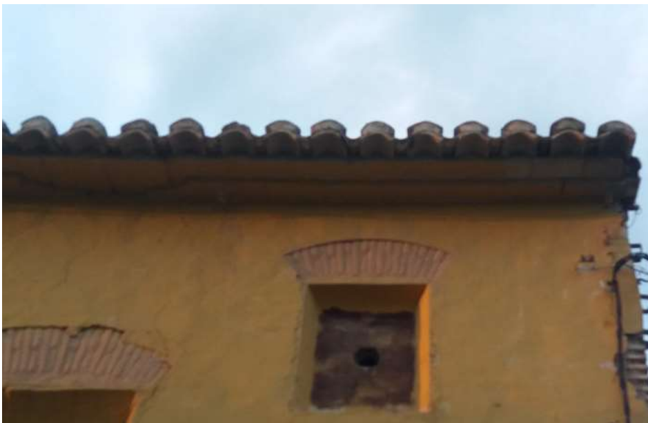
Alquería Albors_ Alero volado sin enlucir
