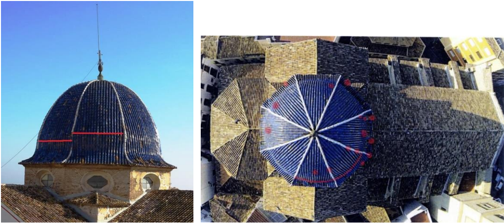
Fig. 4. 9 Ubicación de fisuras y deformación en cúpula exterior.
