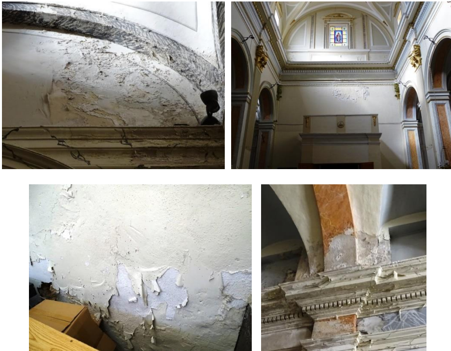
Fig. 4. 8 Humedades al interior.
