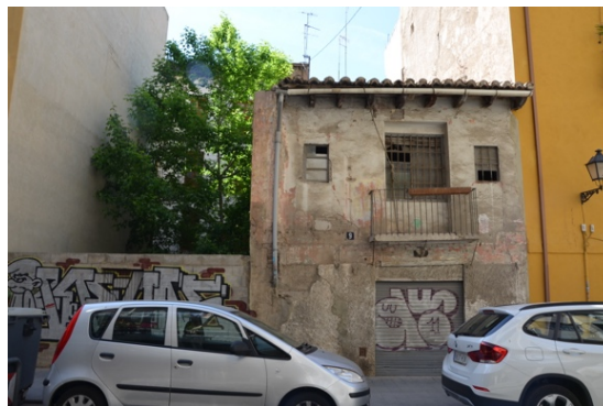
Figura 54. Casa obrador (Andrea Chust Company)
