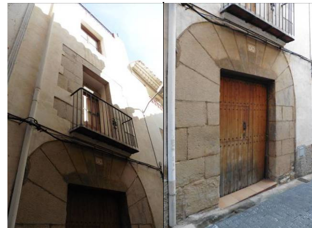
Fig 182 y Fig 182 Casa Abadía Siglo XVII. Destaca la puerta principal adovelada, y los sillares de las esquinas del ventanal. Protección integral. Pese a esto se ha ampliado una altura y modificado la cubierta
