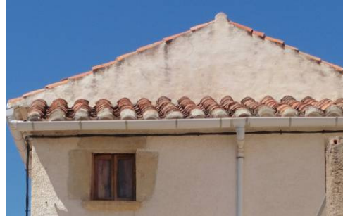
Cubierta a un agua y posterior ampliación de cubierta a dos aguas
