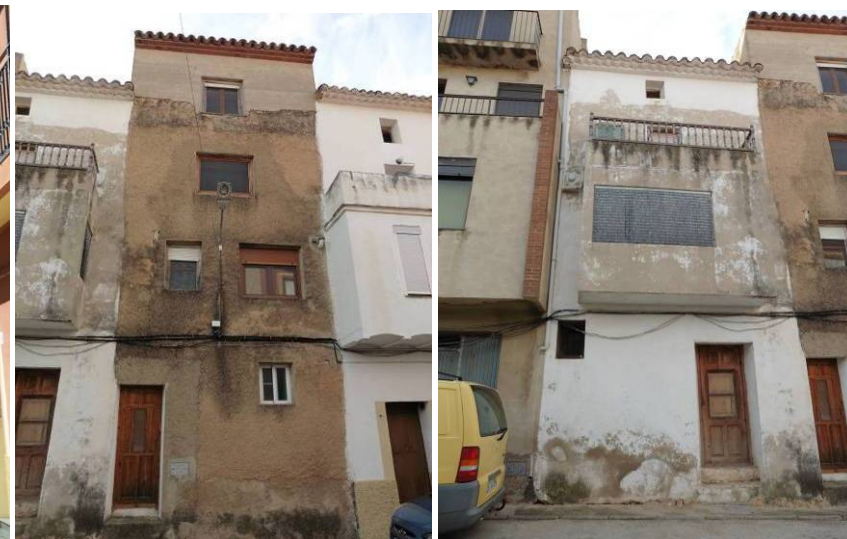
Fig 159 y Fig 160 Humedades en fachadas de esta calle. Fte: Autora
