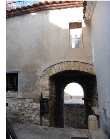
Fig 31 Patología causada por mortero de cemento. Fte: Autora
