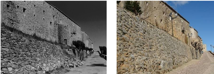
Fig 11 Aspecto de la Muralla de la Ronda San Roque antes de ser intervenida. Fte.: Ayto. Culla
