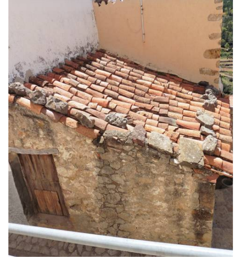
Pérdida de revestimiento de cal
