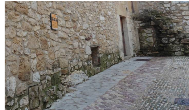
Fig 92 Humedades por capilaridad en el edificio del Hospital. Fte.:Autora
