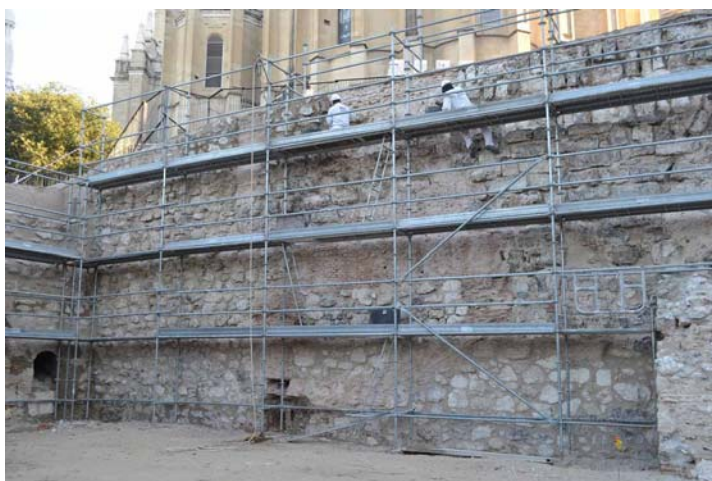
FIG.11.10. Vista general de trabajos de rejuntado en los lienzos de la Muralla.
