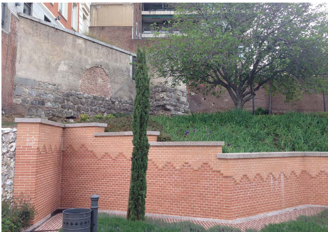
FIG.13.7. Vista general del tramo de Muralla TR5 y torre T4 antes de la restauración.
