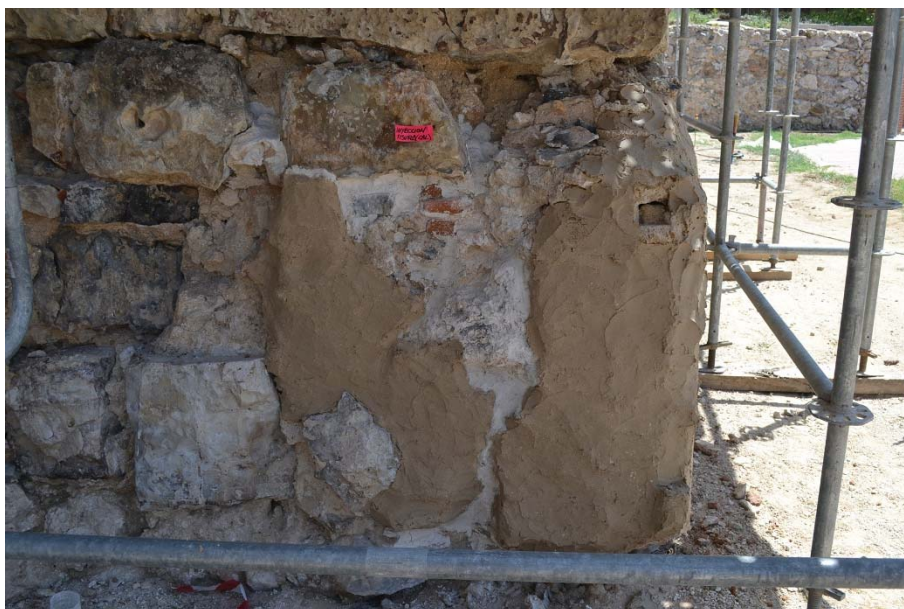
FIG.11.5. Tratamiento de eliminación de sales en la zona inferior de uno de los cubos.
