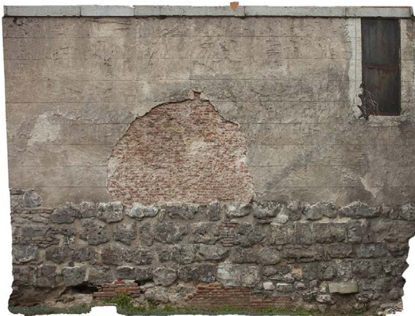
FIG.09.20. Estado del tramo TR5 previo a la intervención.
