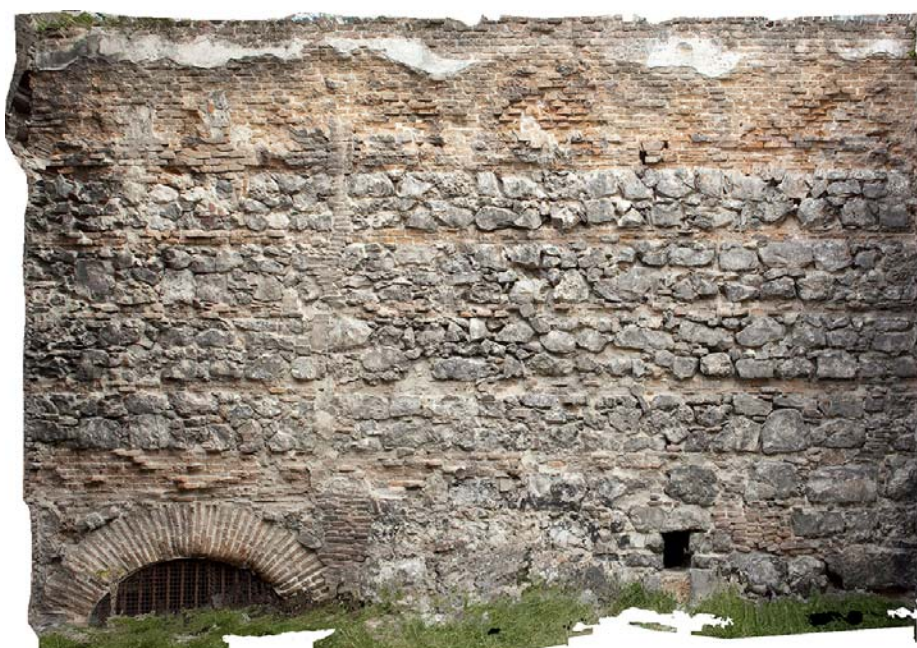
FIG.09.21. Estado del tramo TR7 previo a la intervención.
