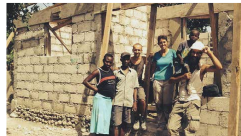
[Fig 12] Reconstrucción de una vivienda mediante técnicas locales en Haití tras el terremoto de 2010.
