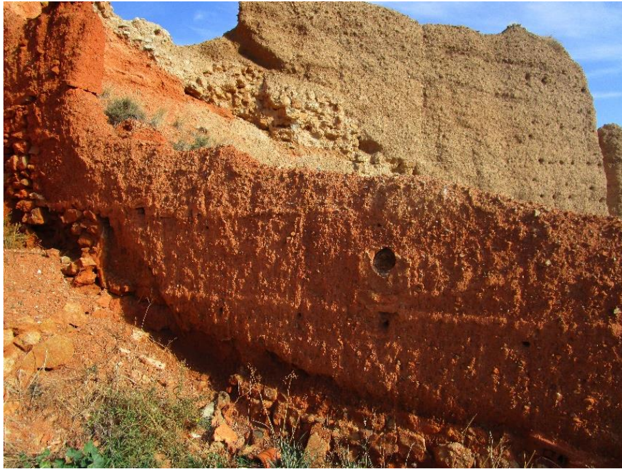
Fotografía 125. Disgregación de materia en coronación de muro de tapial
