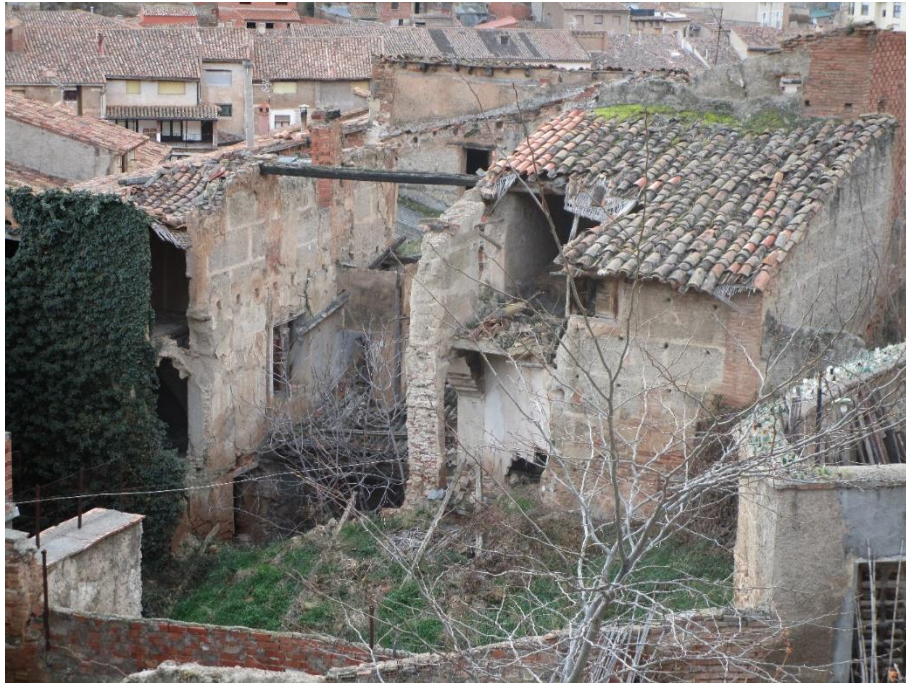
Fotografía 129. Casa abandonada en estado de ruina
