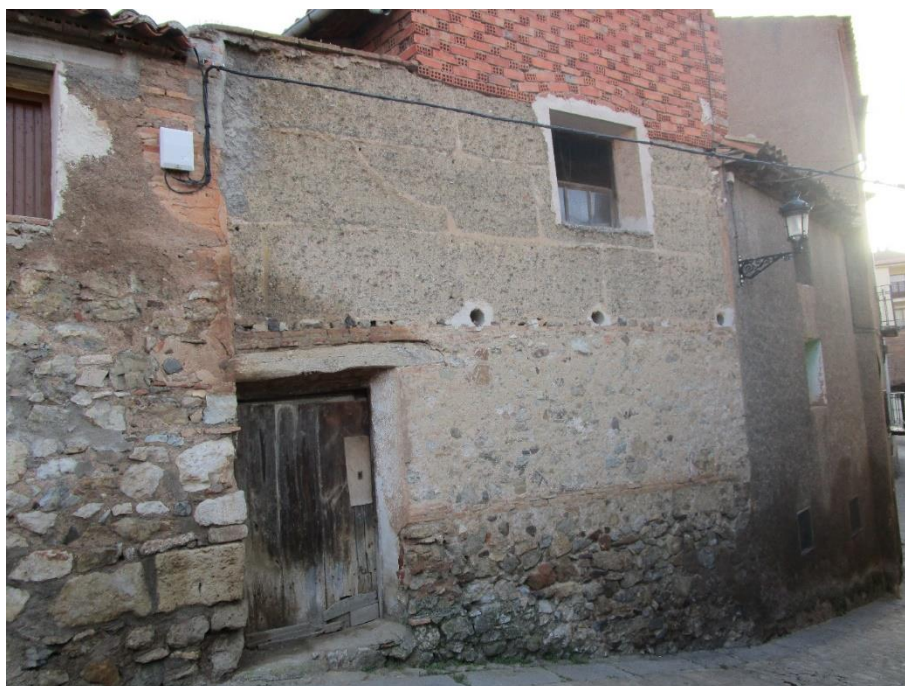
Fotografía 139. Humedades causadas por la urbanización.
