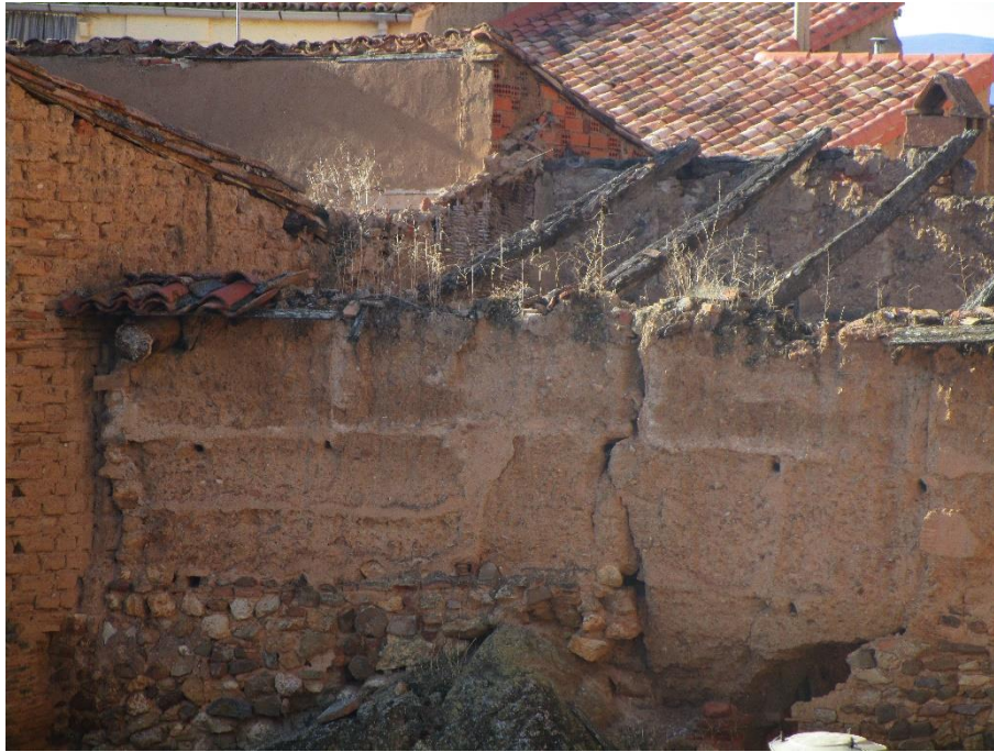
Fotografía 131. Aparición de microorganismos y vegetación en la coronación del muro.
