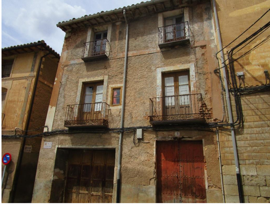
Fotografía 123. Cableado por todo el edificio.
