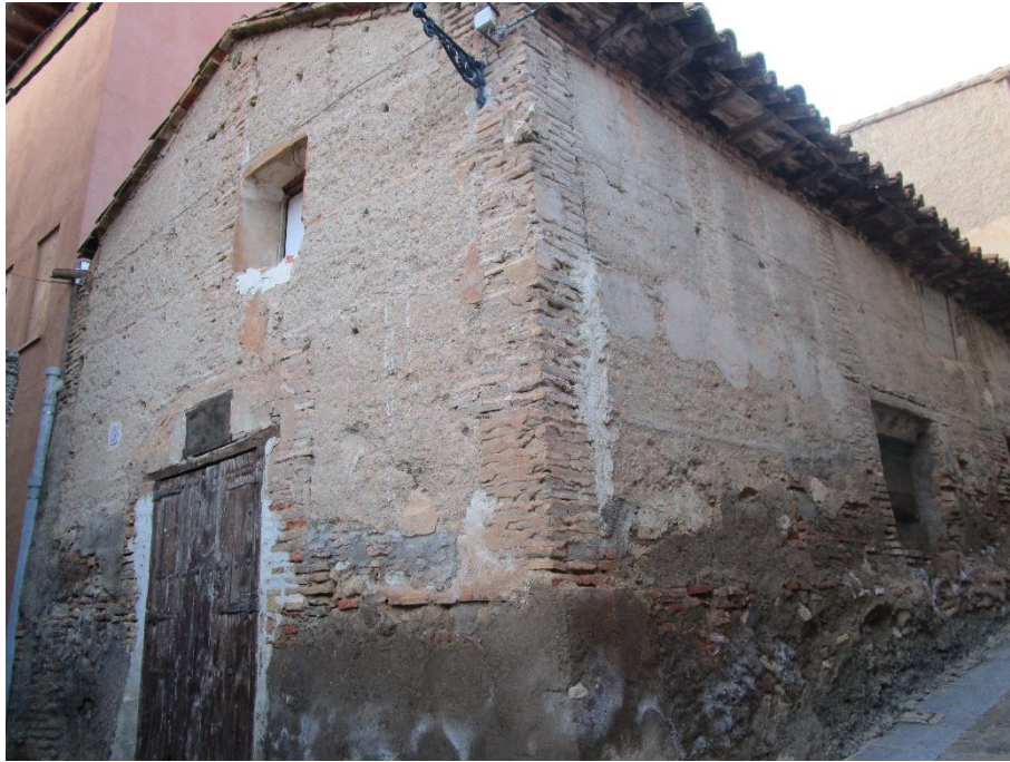
Fotografía 137. Eflorescencias en cemento
