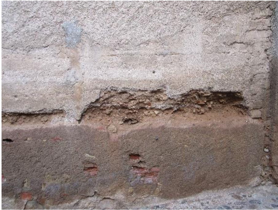
Fotografía 119. Disgregación del material
