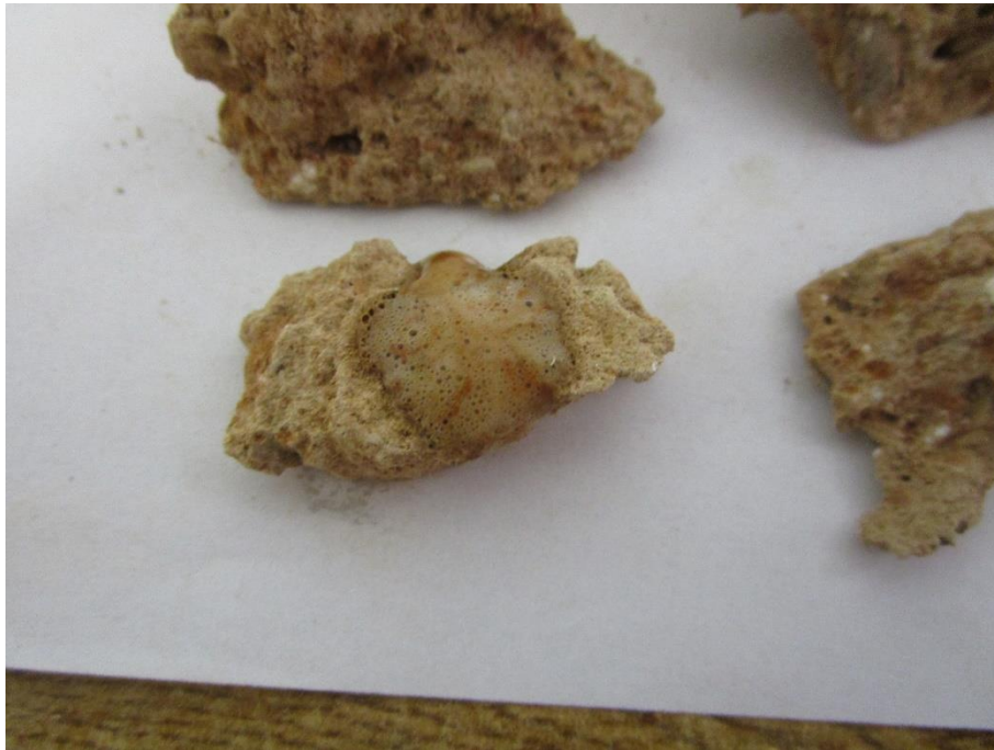
Fotografía 55. Efervescencia en la parte interior del enlucido.
