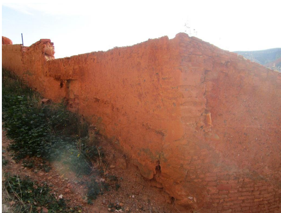
Fotografía 140. Muro de Tapia sin mancha de humedad.
