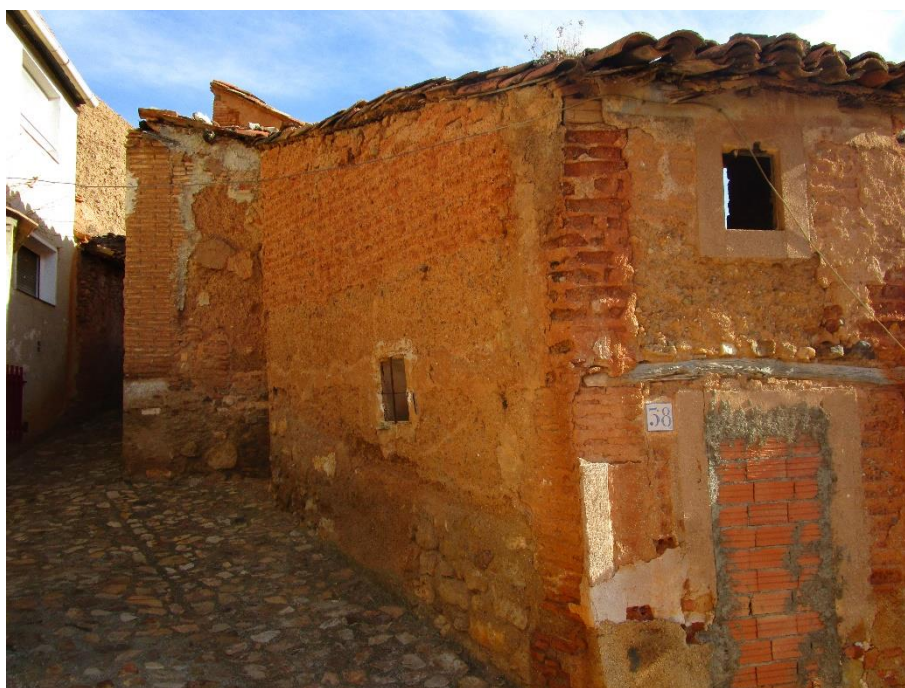
Fotografía 132. Disgregación por inclemencias del tiempo
