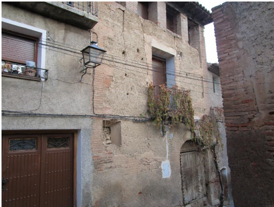
Fotografía 135. Diferentes instalaciones que afectan al edificio.
