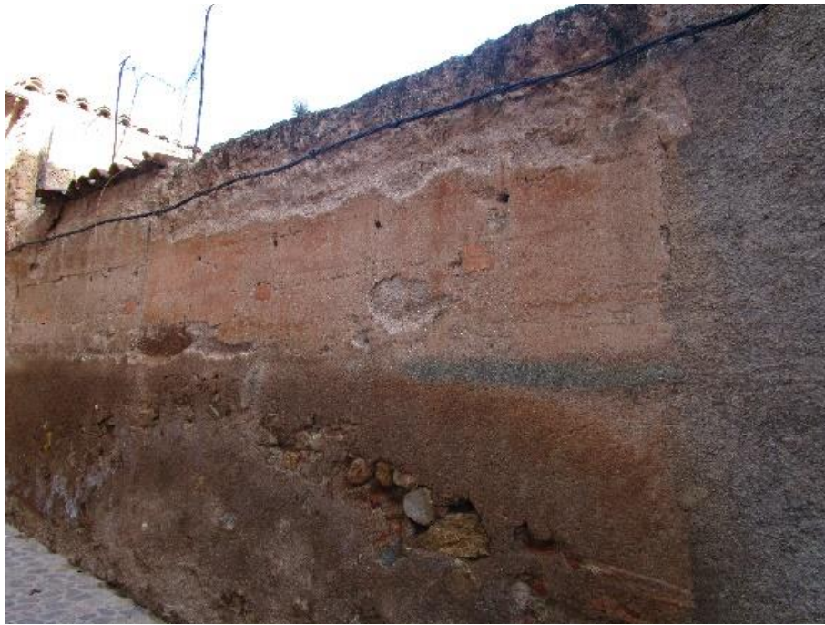
Fotografía 117. Manchas de humedad
