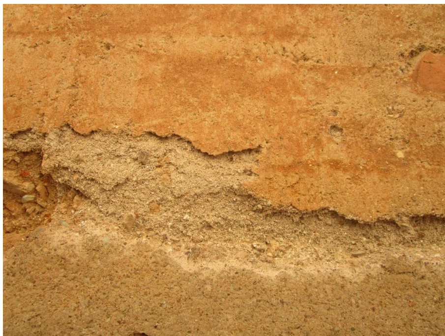
Fotografía 24. Enlucido en la zona de la Judería
