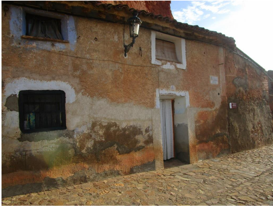
Fotografía 29. Enlucido grueso en la zona bajo el castillo
