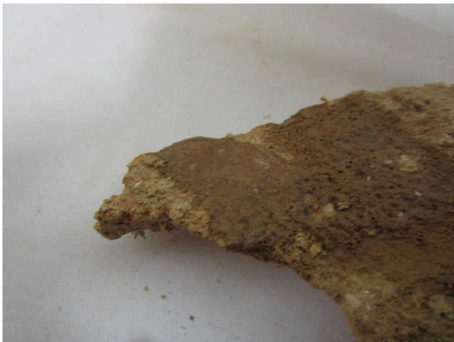
Fotografía 56. Ausencia de efervescencia en la parte exterior del enlucido
