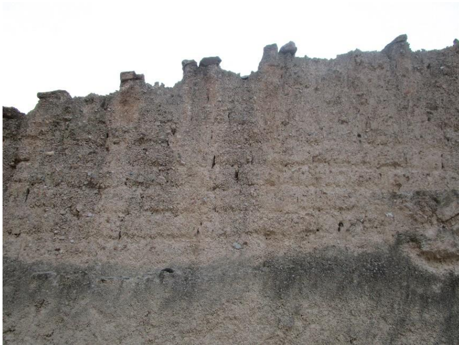
Fotografía 126. Disgregación de material en coronación de muro de adobe
