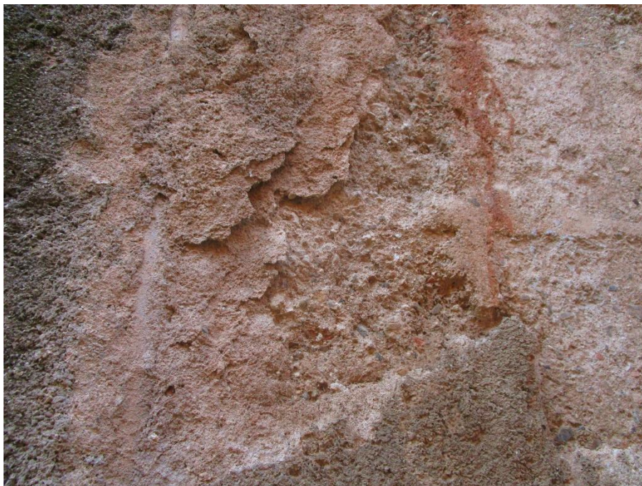
Fotografía 48. EL005, enlucido en la calle San Jorge 20
