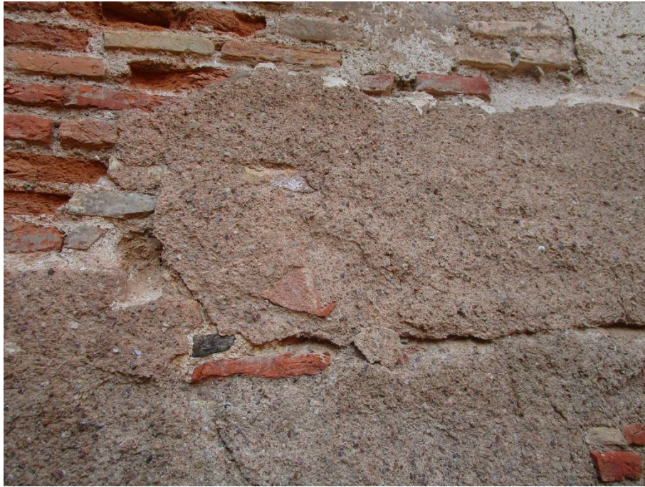
Fotografía 45. EL004, enlucido en la calle San Jorge 8
