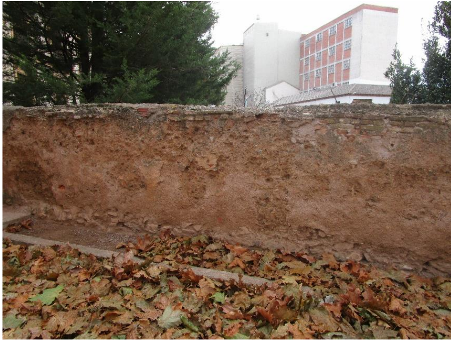
Fotografía 127. Elementos impropios en la coronación
