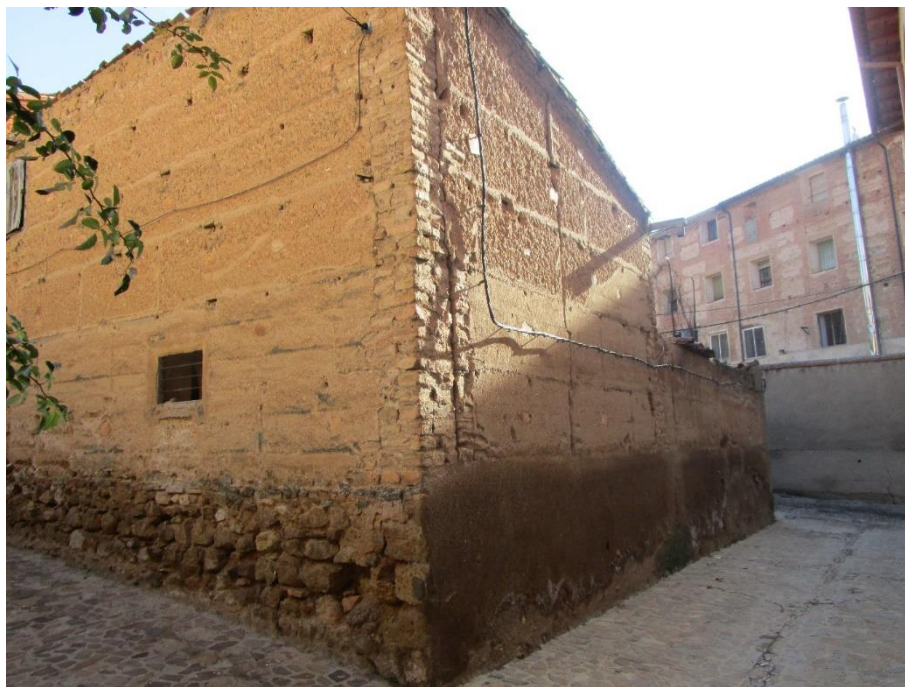
Fotografía 136. Manchas de humedad por capilaridad
