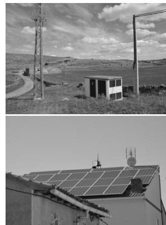
Imagen 4.4 y 4.5. Suministro eléctrico
