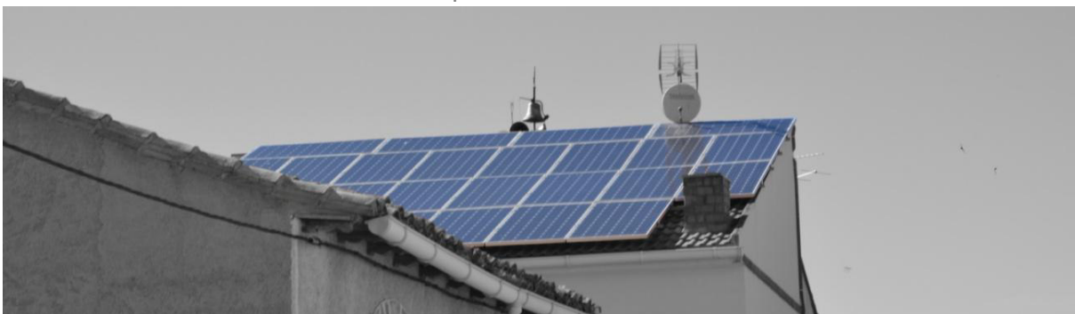
Instalación fotovoltaica en núcleo urbano -C/Italia nº26-
