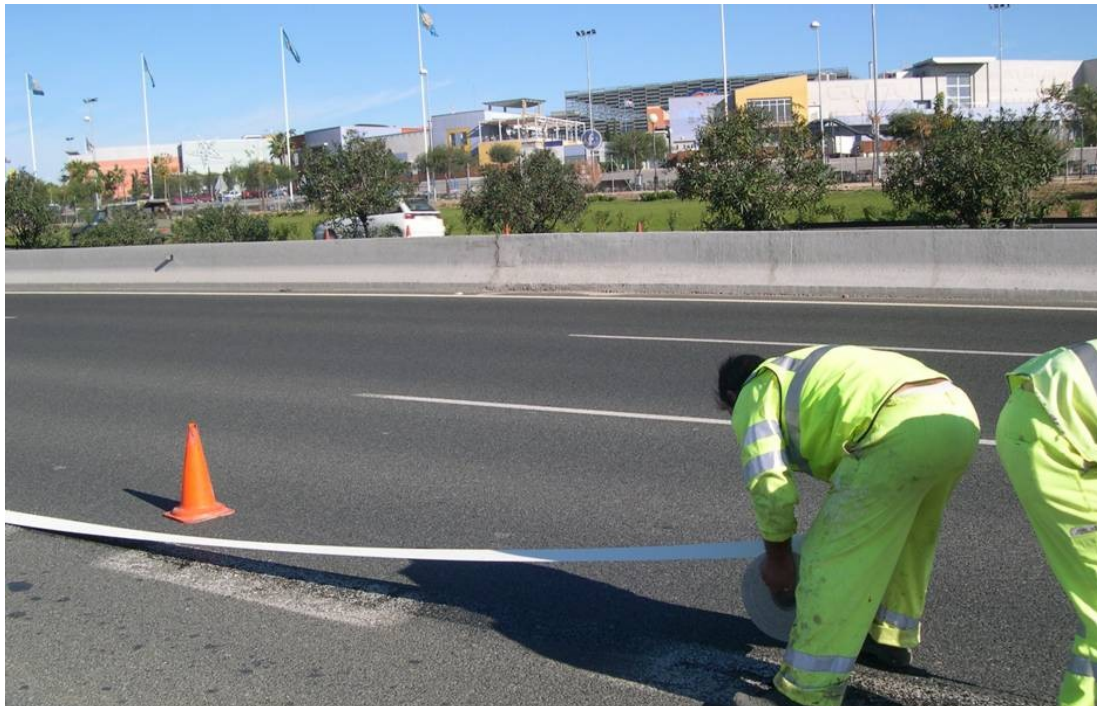
Figura 77: Utilización de cinta para la señalización provisional
