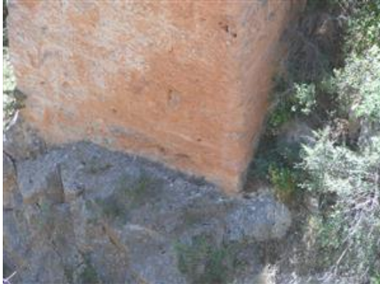
Figura 44. Vista de la cimentación de los pilares sobre roca. Fuente: elaboración propia, 2015
