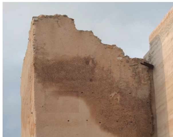
Figura 6. Aparición de humedades tras la restauración de una fábrica de tapia incorporando conglomerantes incompatibles Villa de Alpuente
