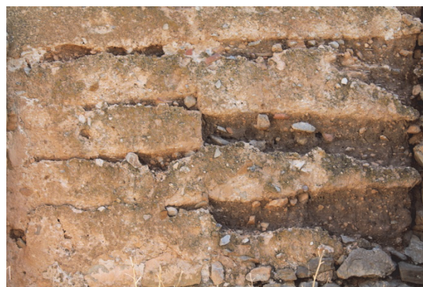
Figura 4. Desprendimiento de costra en una tapia calicostrada. Cañada Seca
