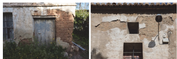
Figura 12. Pérdida del revestimiento exterior y presencia de vegetación en muro de adobe y tapia valenciana respectivamente (C.Cazorla)
