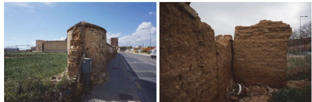
Figura 14. Desplome de un muro de tapia valenciana; grieta y derrumbe de un muro de adobe (C.Cazorla)
