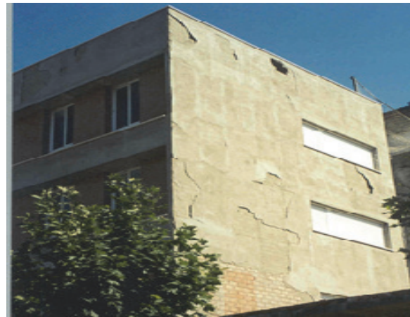
Figura 1. Desprendimiento de mortero de revestimiento por inadecuado curado.
