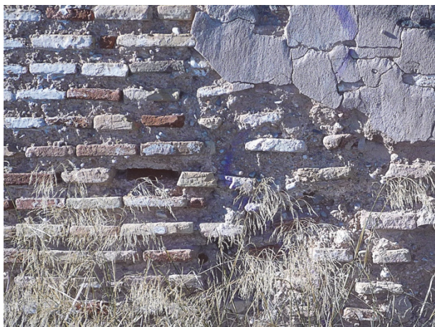
Figura 4. Detalle del encuentro entre los dos tipos de tapia valenciana en la fachada principal de la Alqueria del Pollastre (Gómez Patrocino, F. J.).
