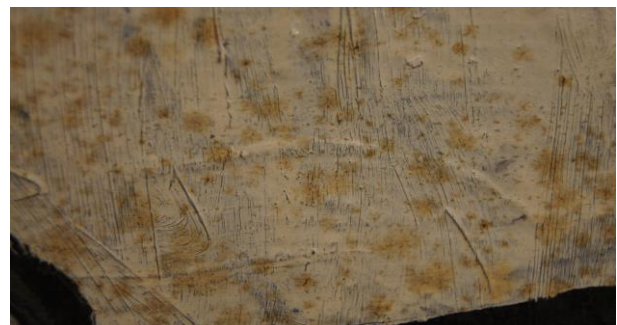
Figura 13. Detalle de manchas de humedad y hongos
