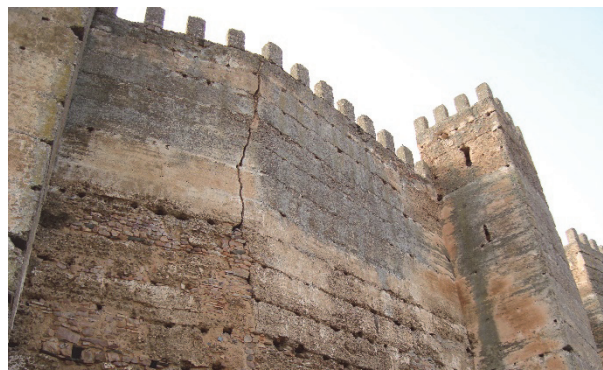
Figura 6. Detalle de la imagen actual del lienzo entre los torreones 8 y 9 en la que se detecta la fi sura vertical.
