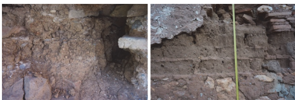
Figura 13. Deterioro del núcleo de tierra en muro de tapia valenciana y erosión de los bloques de adobe (C.Cazorla)
