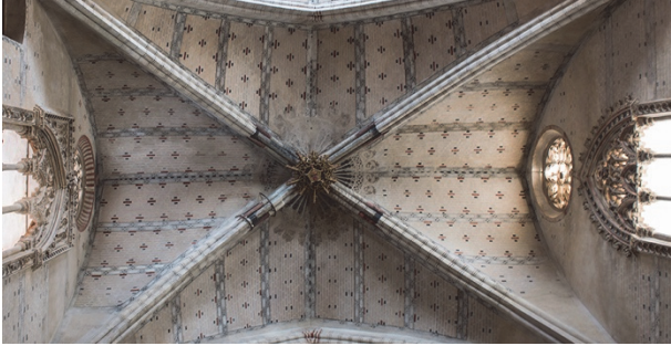
Figura 4. Bóveda del tercer tramo de la iglesia de la Virgen de Tobed
