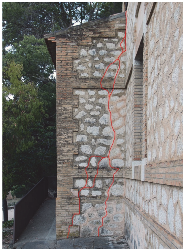
Figura 6: Fisuras. Mapeado de lesiones. Estado actual año 2015
