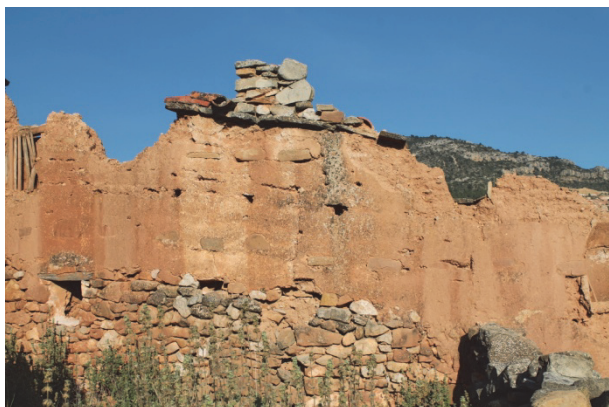
Figura 5. Degradación progresiva de los muros de tapia por abandono del edificio. La Hortichuela
