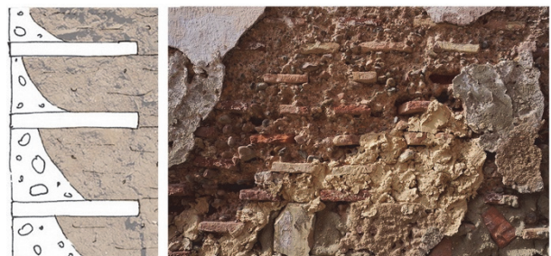
Figura 7. Detalle de un muro de tapia valenciana tipo II (C.Cazorla)
