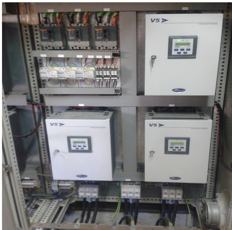
Figura 6:Detalle de los arrancadores electrónicos de las bombas.
