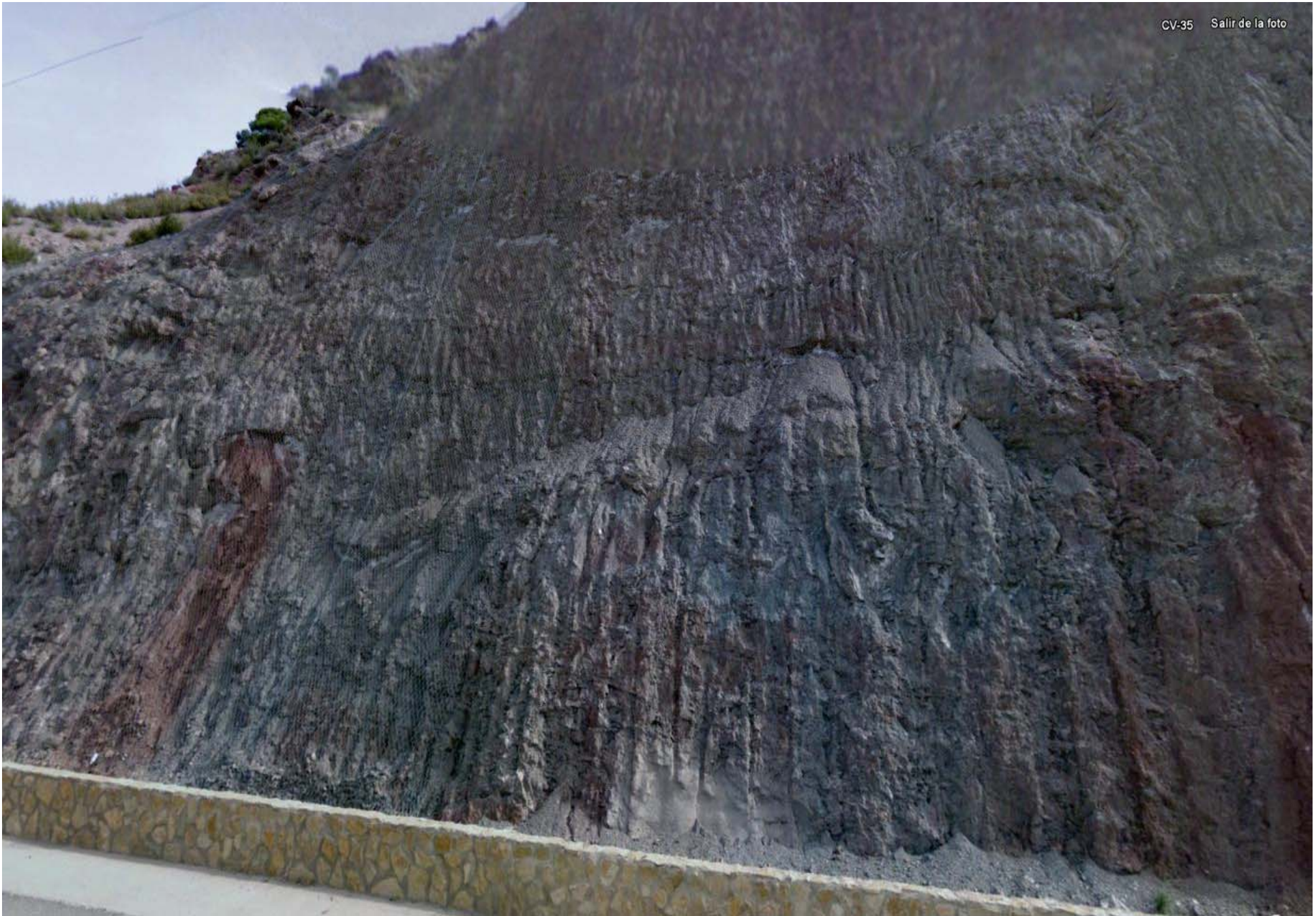
Hacia zona 4 . En esquina izquierda imagen anterior. Materiales del Triásico- Keuper. De colores intensos- arcillas, arenas, margas con yeso- con tela metálica y muro para evitar caídas en carretera
