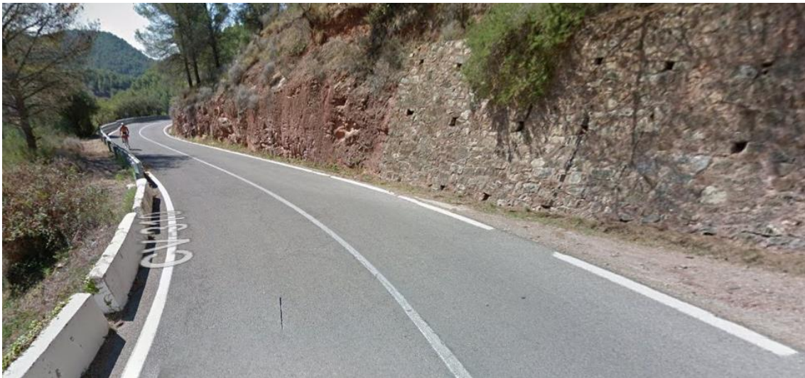
Imagen 37: ejemplo muro de contención de tierras 8 (Contenidos audiovisuales/capturas de Google/ El Tochar-Serra/P.K. 22+000 (378).jpg)
