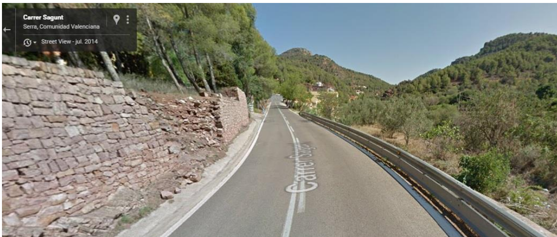
Imagen 38: ejemplo de primer muro de contención de tierras parcialmente derruido 1 (Contenidos audiovisuales/capturas de Google/Serra-El Tochar/P.K. 21+000 (39).jpg)
