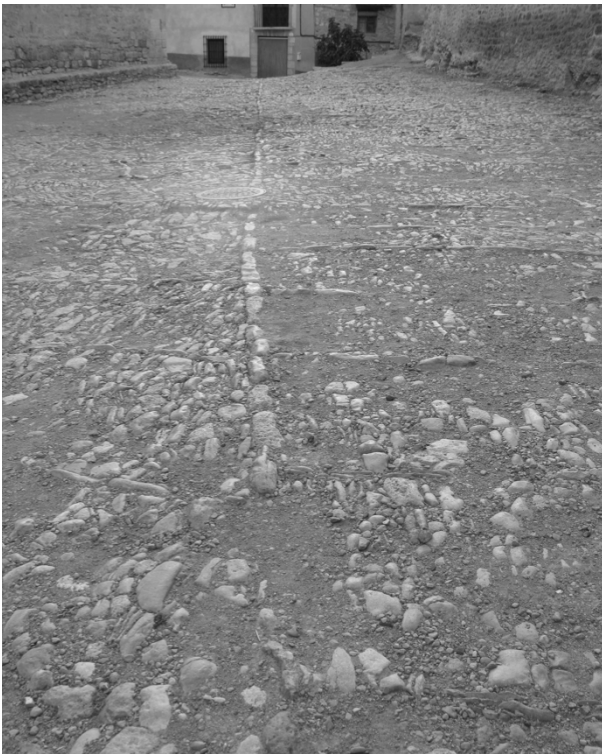
Figura 2. Imagen del estado previo del pavimento.
