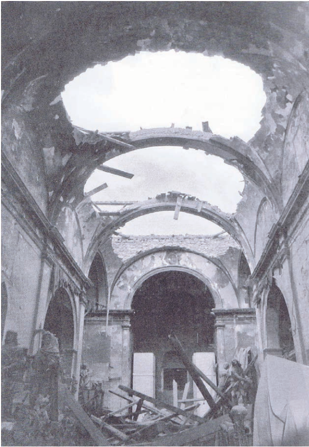
Figura 4. Hundimiento de la techumbre de la iglesia en 1993. (Imagen R. Redó)
