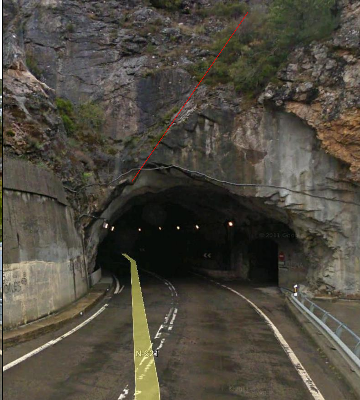
Túneles sin revestimiento- con gunitado y fallas- estribos der. E izq. Extremos cerrada Embalse de Riaño, León. Centro N Hoja.
