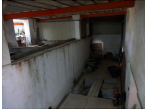
Imagen 1. Planta baja. Zona de llenado de depósitos.
