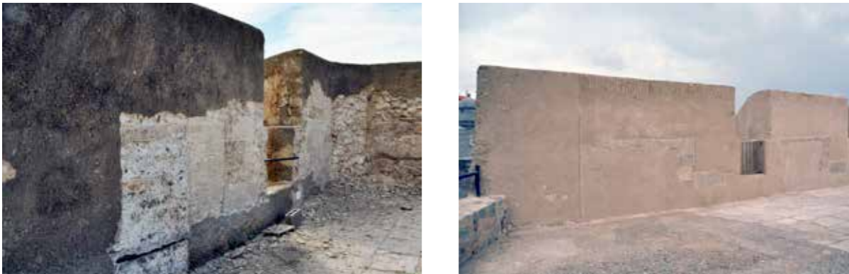
Merlones de la zona sur cuando se descubrieron restos de los remates originales (MJB 2009) y después de la restauración (MJB 2013)
