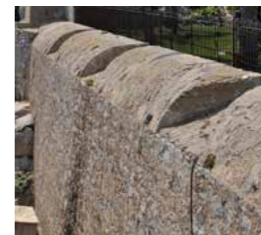
Fig. 4.4.67. Parapeto abocelado de fábrica con troneras, en el muro relizado entre baterías baja y alta del Maset. (MJB 2012).
