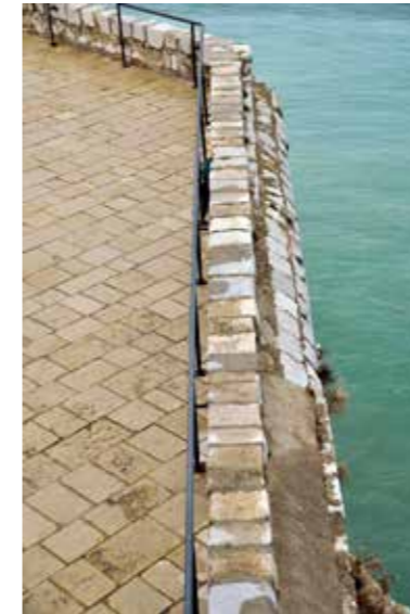
Fig. 4.1.199. Base de paramentos de sección curva en la terraza del castillo. Probablemente construidos en las mismas obras de fortificación del castillo. (MJB 2016).
