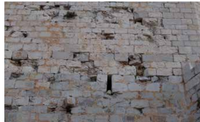
Fig 4.1.55. Vierteaguas de desagüe de la cisterna y hueco de ventilación de la sala del fondo del establo, vistas desde la plaza de la Ermitana. (MJB 2015).
