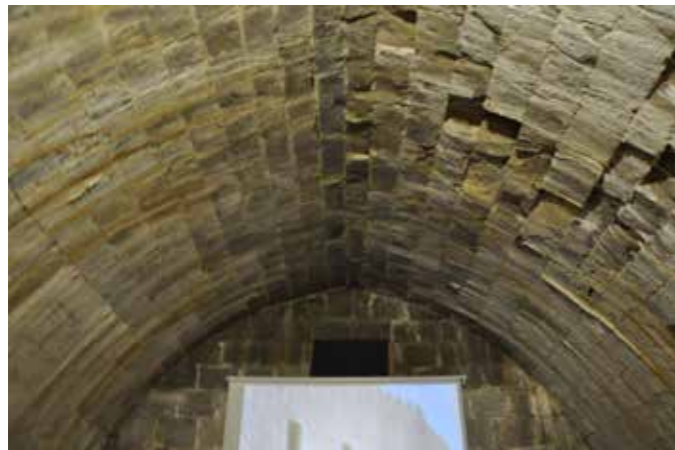
Deterioro por humedades en la bóveda de Estancia del primer nivel bajo la cubierta de la Torre del Homenaje (MJB 2010)
