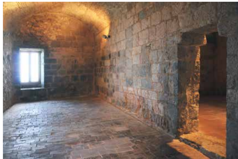
Fig. 4.1.79. Vista interior de la sala 8 después de la restauración. Muro original de sillería y hueco de comunicación con la sala anexa que antes se hallaba cegado. (MJB 2015).
