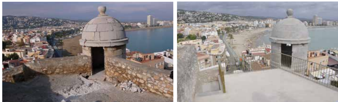
Plataforma de la garita de Felipe II. Durante la ejecución de las catas iniciales (MJB 2011) y después de la obra (MJB 2012)
