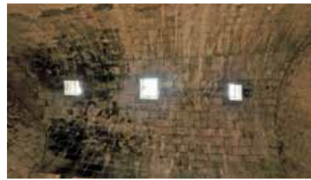
Fig. 4.1.135. Huecos en la bóveda. (MJB 2012)
