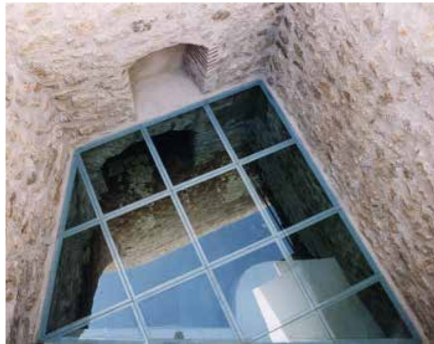
Vista huecos de la muralla y lucernario sobre el manantial después de las obras. (MJB 1999).
