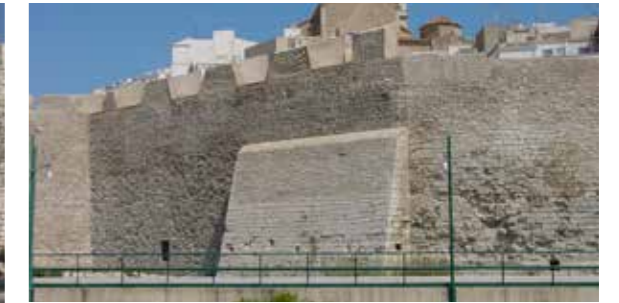
Vista de la batería de Santa Ana después de las obras. (MJB 2002).
