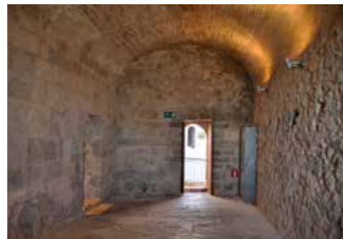
Fig. 4.1.80. Interior de la sala 8 después de la restauración. Vista hacia la entrada. (MJB 2015).
