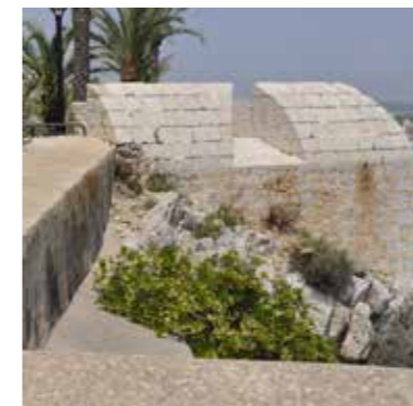
Fig. 4.4.65. Parapeto abocelado de cantería con troneras en Boctoglio, que une con otro recto de fábrica. (MJB 2012).
