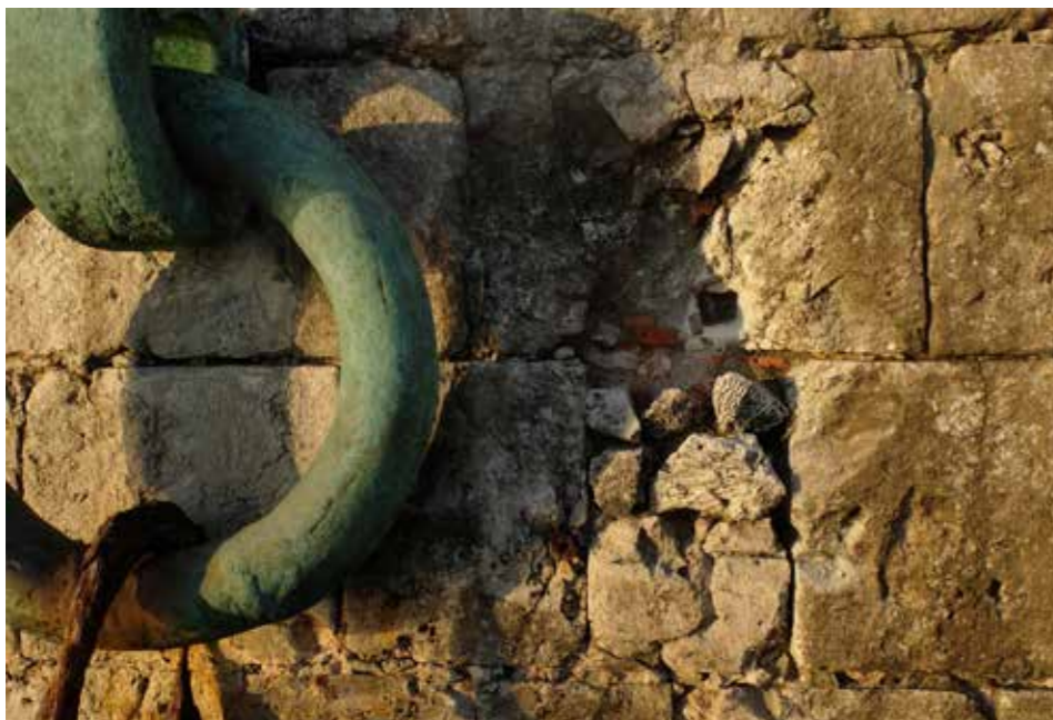
Fig. 4.2.112. Muro de la fortaleza de San Juan de Ulúa. Detalle del muro de piedra coralina y de las argollas diseñadas por B. Antonelli para cerrar con cadena el puerto de Veracruz (México). (MJB 2015).
