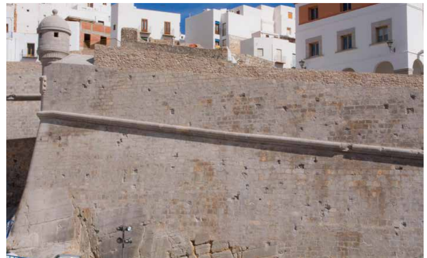
Fig. 4.2.78. Vista de la cortina de San Felipe con el Balcón de Pilatos y la garita después de la restauración. (MJB 2012),
