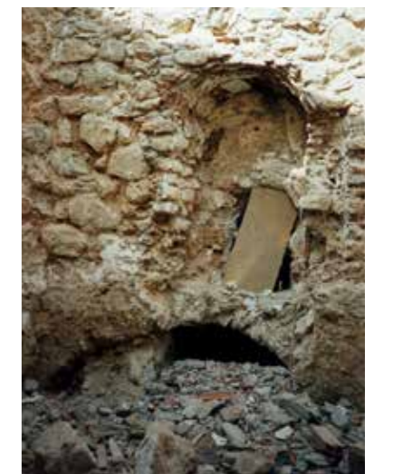
Fig. 4.3.12. Vista del arco de acceso a la caja de la Fuente y hornacina superior, en las obras de restauración (MJB 1998).
