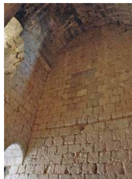
Fig. 4.1.142. Muro de separación con la casa de la cisterna. Huevo de comunicación cegado (MJB 2012).
