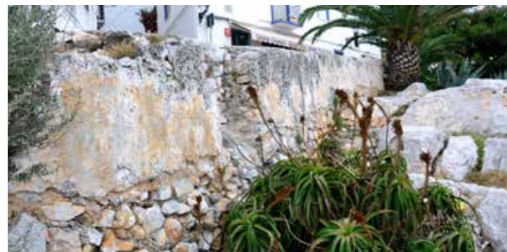
Fig. 4.4.27. Muro de Santa Bárbara. Grafitos fuera de la zona de actuación del proyecto de restauración. (MJB 2009).
