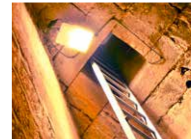
Fig. 4.1.38. Sillares labrados a medida en el hueco de la bóveda del aljibe de la casa de la Cisterna. (MJB 2014).
