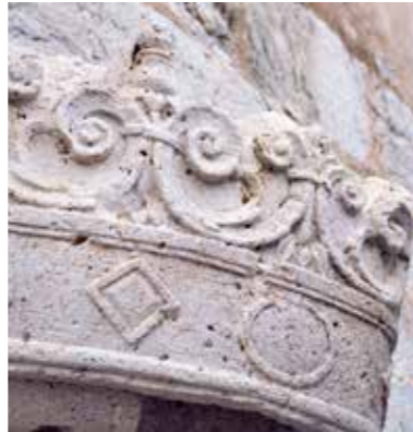
Fig. 4.2.123. Detalle del escudo de la esquina sur del baluarte Real después de la restauración. (MJB 2013).
