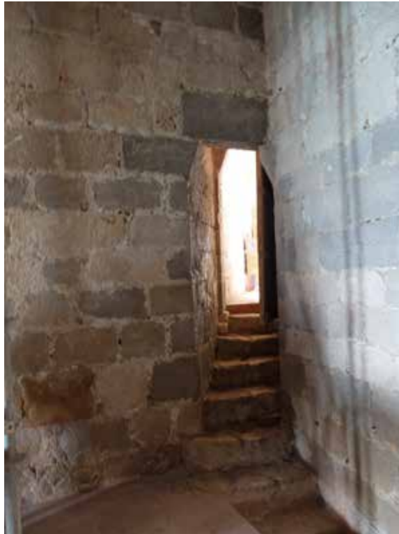
Fig. 4.1.92. Vista de la escalera al hacer las catas, antes de levantar el pavimento moderno. (MJB 2014).
