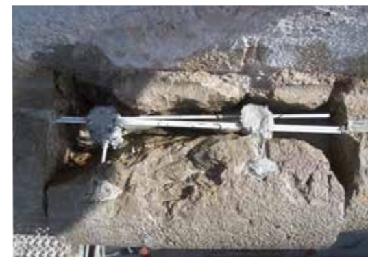
Pieza de cordón afectada por impacto en fase de restauración incorporando refuerzo varilla fibra de vidrio para poder anclar la parte suelta (MJB 2012)
