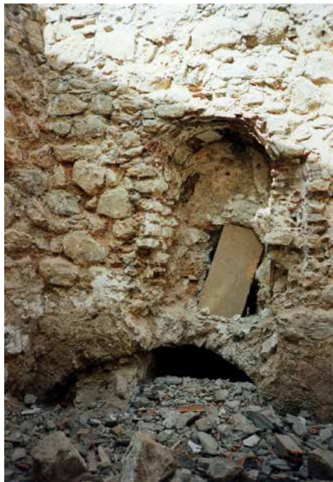
Vista del huecos cegados en la muralla antes de las obras. (MJB 1997).
