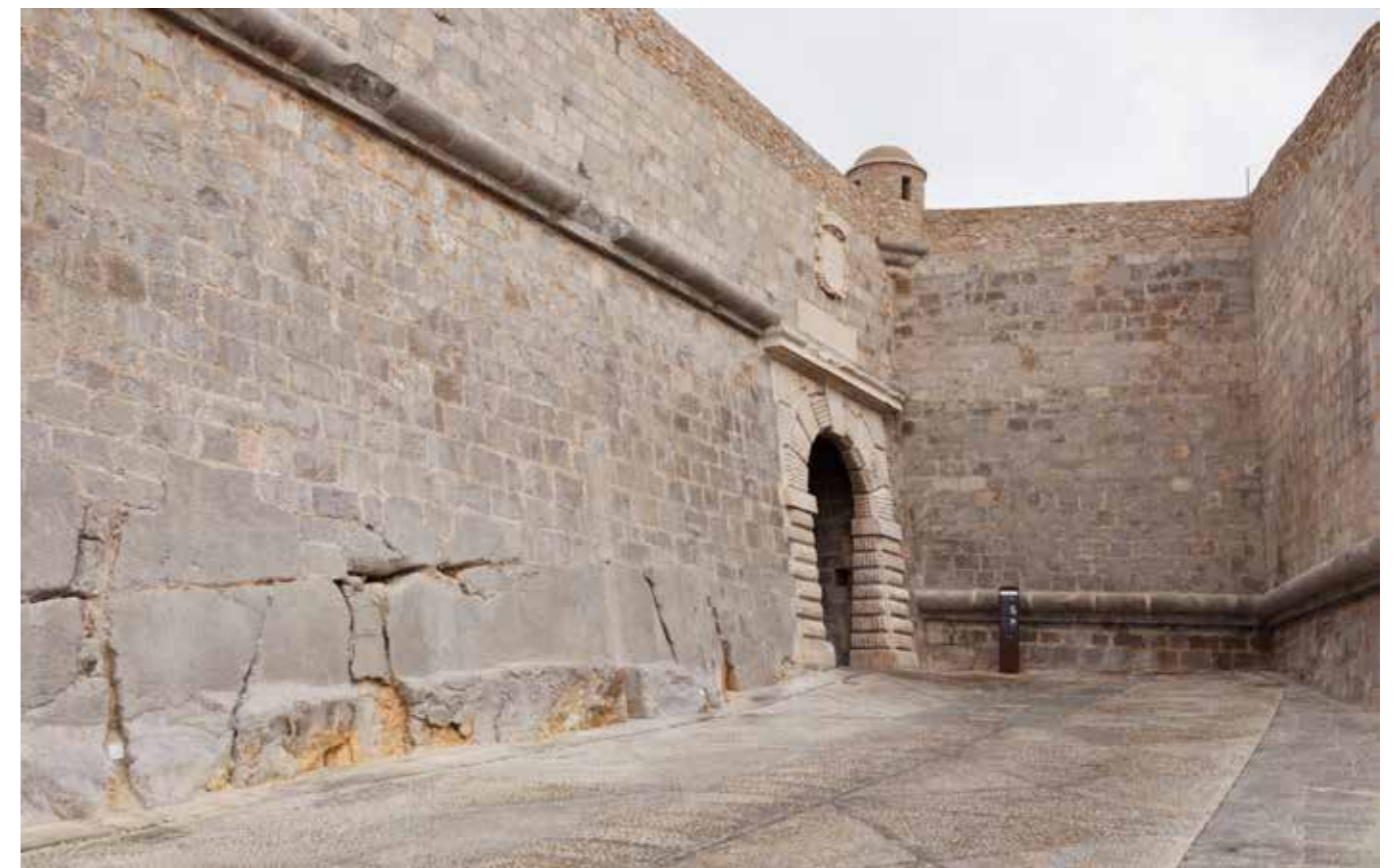
Cortina del Olvido y portal Fosc, antes (MJB 2010), y después de las obras (MJB 2012).
