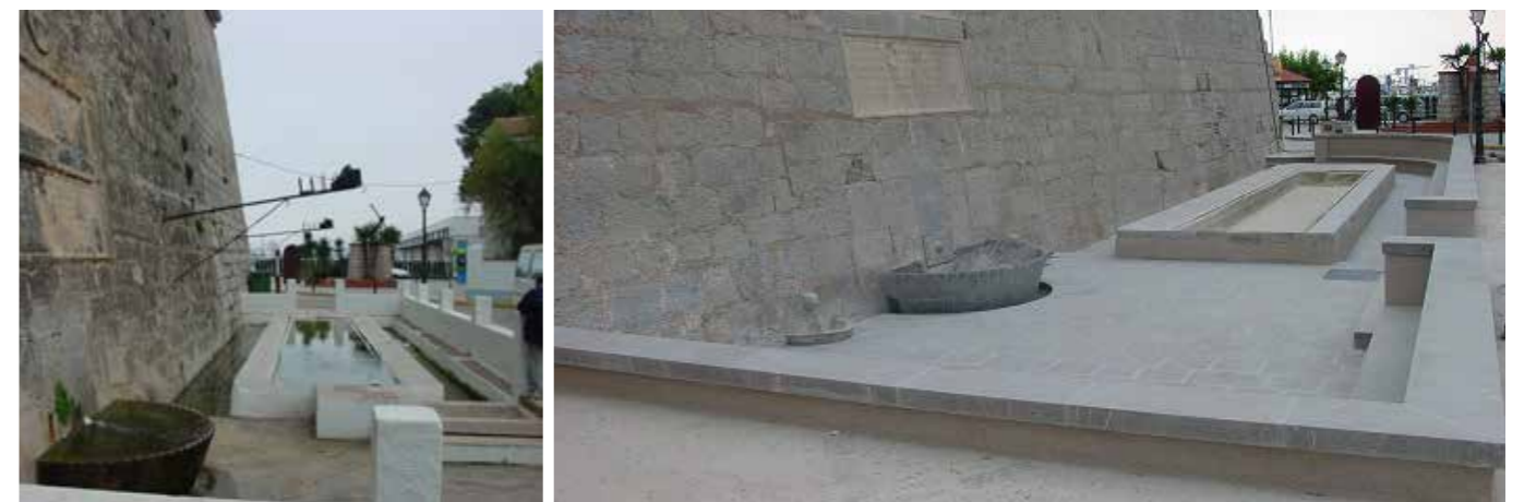
Vista de la fuente de la Pechina antes y después de las obras. (MJB 2000) (MJB 2002).
