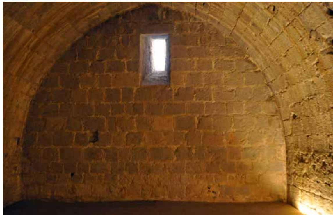
Fig. 4.1.62. Cámara bajo la torre suroeste. Tragaluz hacia la Plaza de Armas. (MJB 2015).
