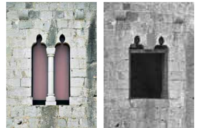
Fig. 4.1.132. Ventana ajimezada del salón gótico, con la columna parteluz reconstruida probablemente a mediados del siglo XX. A la derecha antes de la reconstrucción.
