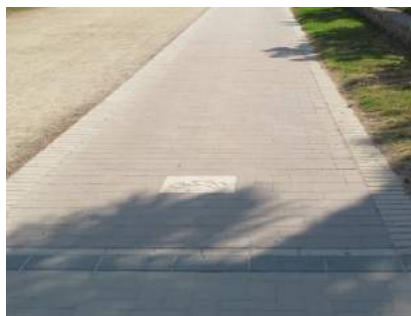
49 Señalización horizontal de carril bici
