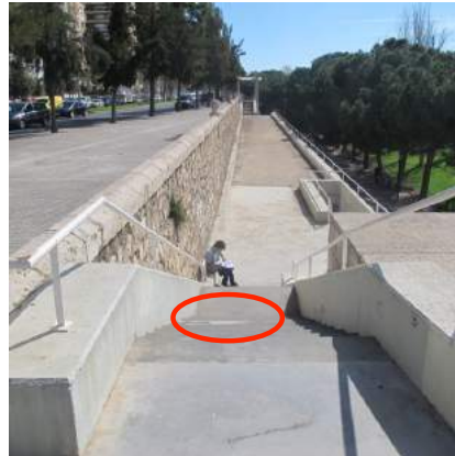
Rotura del revestimiento en el peldaño
