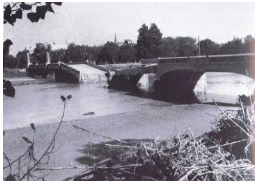
Puente de la Exposición demolido en la riada 17
