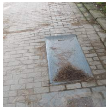
Trapa de instalaciones en el itinerario peatonal
