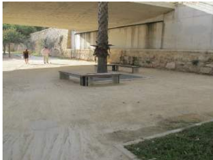
Erosión del pavimento por las rodaduras de los ciclos
