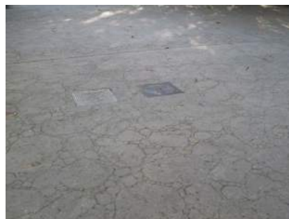
Registros de instalación enrasados sobre la rasante de la banda peatonal
