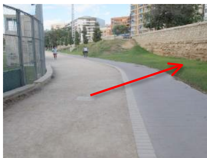
Registros de instalaciones en el Itinerario peatonal
