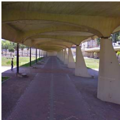
Falta de pavimento de advertencia en el cruce con el itinerario peatonal.
