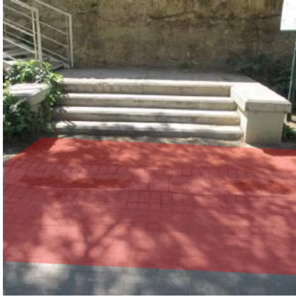
Falta de señalización vertical y horizontal por cruce de carril bici en el acceso al cauce por escalera
