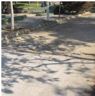
Discontinuidad del pavimento margen izquierdo del IT03
