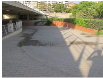
Vista cota superior de Rampa 9B que enlaza bajo el puente con el tramo 10
