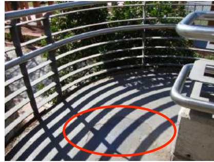
Meseta de cambio de dirección. Falta mantenimiento
