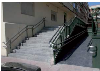
Pasamanos doble instalado en ambos lados 83
