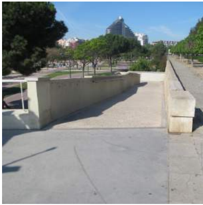
Carencia pavimento señalizador al inicio rampa
