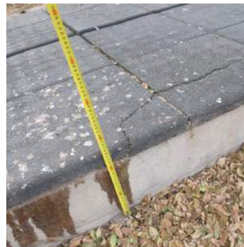
Desnivel entre el pavimento de acceso y el área de juegos
