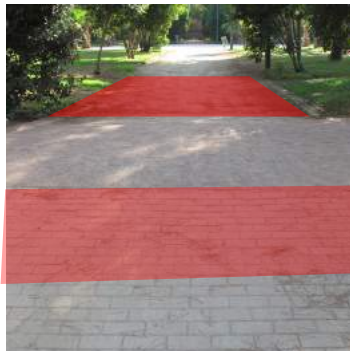
Pavimento táctil señalizador
