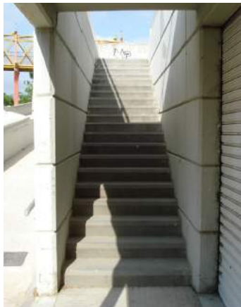
Falta de pasamanos en ambos lados
