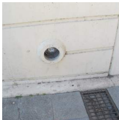
Falta de mantenimiento de las luminarias tipos de ojo de buey
