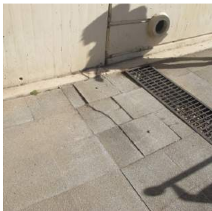
Falta de mantenimiento del pavimento
