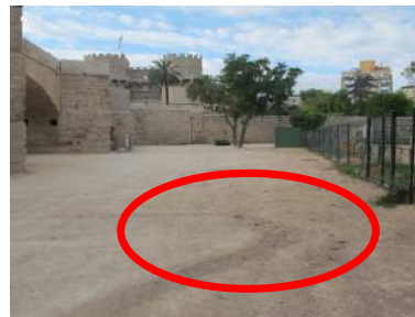
Erosión del pavimento de arena morterenga
