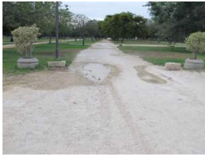
Pavimento dañado inicio itinerario
