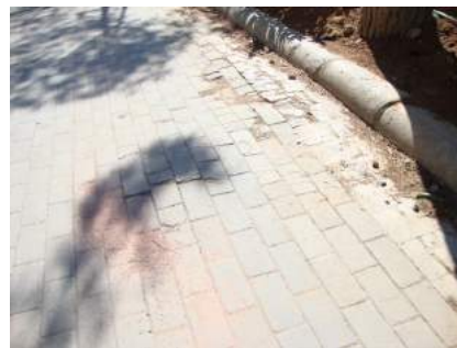
Pavimento afectado por accion de raices
