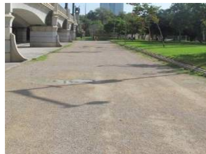
Hundimiento del terreno con acumulación de agua
