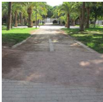
Carece de pavimento señalizador en el cruce del carril running
