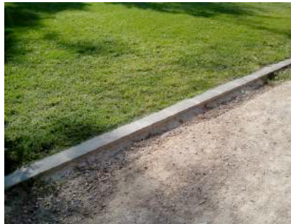
Erosión del pavimento de arena morterencia
