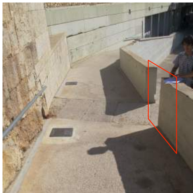
Falta de continuidad muro de antepecho
