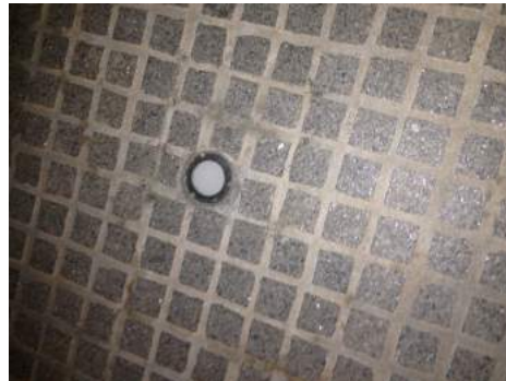
Mal funcionamiento de la luminaria
