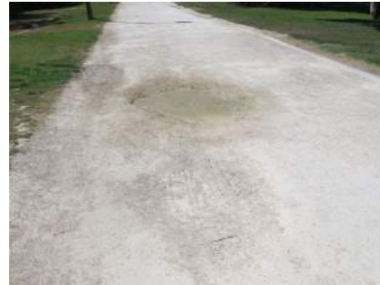
Pavimento dañado que precisa mantenimiento
