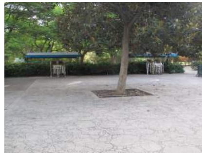
Alcorques que precisan de protección
