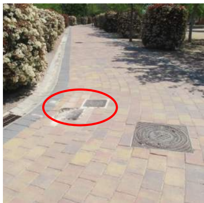
Hundimiento de trapa de instalaciones
