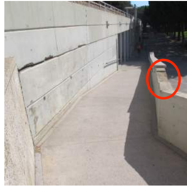
Falta de coronación de antepecho.
