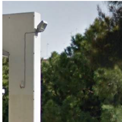
Iluminación tipo halógeno para iluminar la escalera
