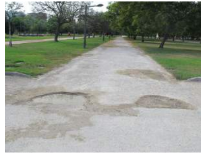
Pavimento dañado intersección IT02
