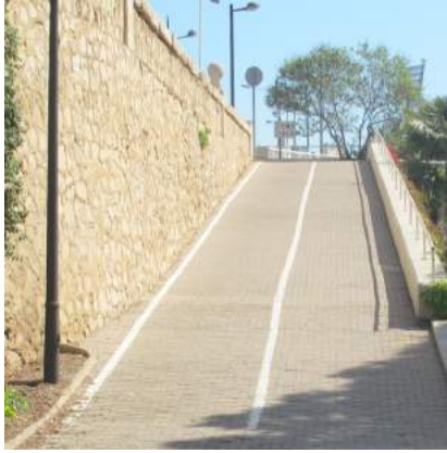
Falta de rellanos intermedios cada 9,00 metros
