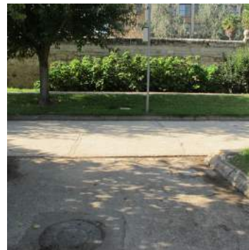
Discontinuidad del pavimento margen derecho del IT03
