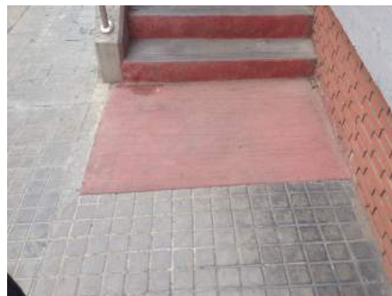
Pavimento táctil señalizador
