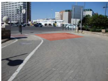
Falta de pavimento señalizador
