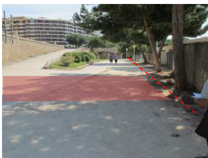
39 Falta de pavimento señalizador y bordillo
