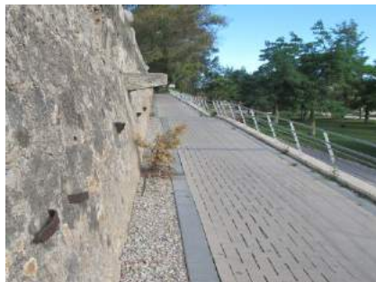
Retranqueo para evitar cabezada con mechinal de muro de contención
