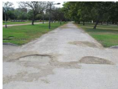
Pavimento dañado intersección IT02
