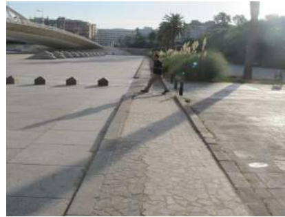
Alcorques que precisan de protección
