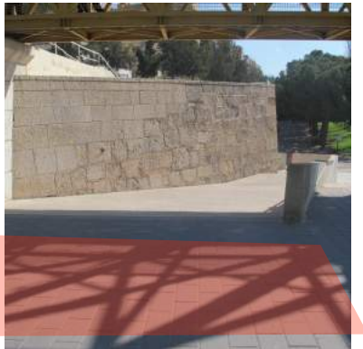
Falta de pavimento señalizador
