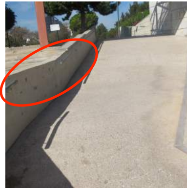
Falta de continuidad de los pasamanos
