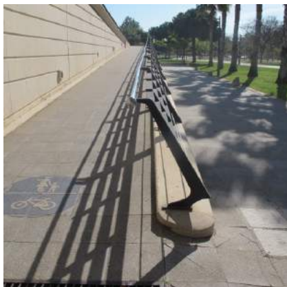
Barandilla rampa no escalable
