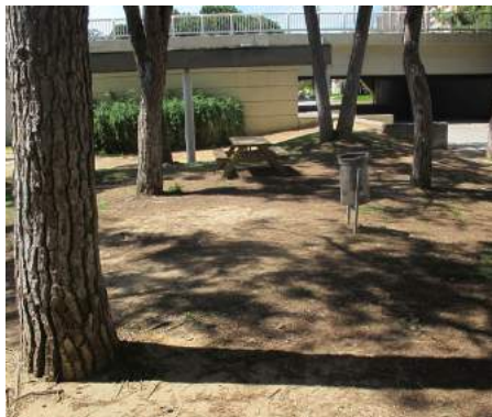
Pavimento en mal estado por falta de mantenimiento
