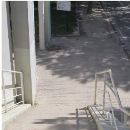
Falta de pavimento táctil indicador en el embarque
