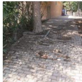
Levantamiento del pavimento por la acción de las raíces
