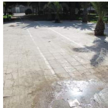
Zona central con acumulación de agua
