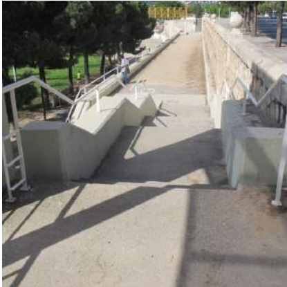
Falta de pavimento señalizador en el embarque
