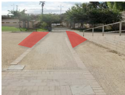
Falta de pavimento de advertencia en el cruce con el carril bici
