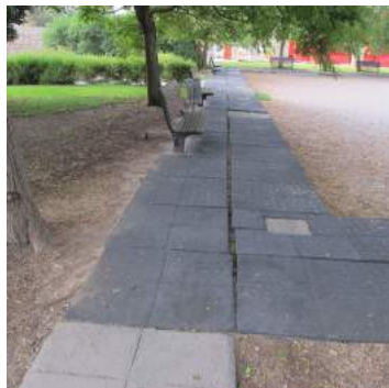
Losetas en mal estado
