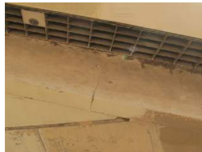
Detalle reja de proteccion alumbrado
