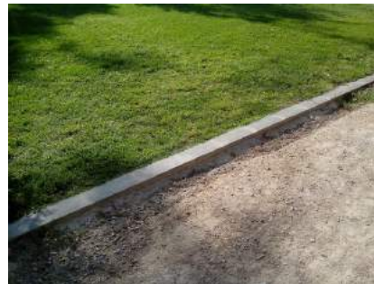
Erosión del pavimento por efecto de los agentes atmosféricos
