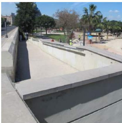
Falta la colocación de pavimento señalizador al inicio de la rampa
