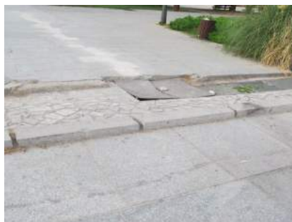
Falta de continuidad en la rasante al inicio del itinerario por presencia de instalaciones.
