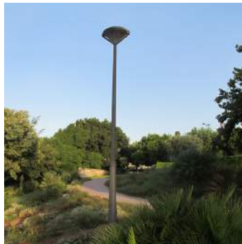
Luminaria de Poste
