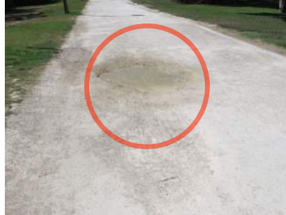
Acumulación en agua por falta de compactación de la arena morterencia
