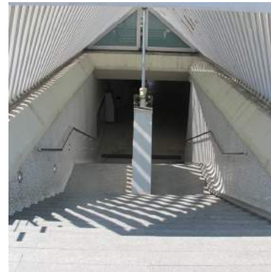
Falta de pasamanos en el primer tramo
