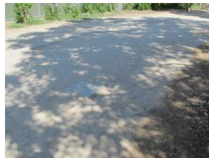
Registros y pavimento disgregados en zona de circulación
