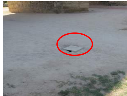
Registros de instalaciones en mal estado
