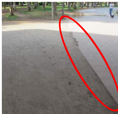
Falta continuidad de pavimento
