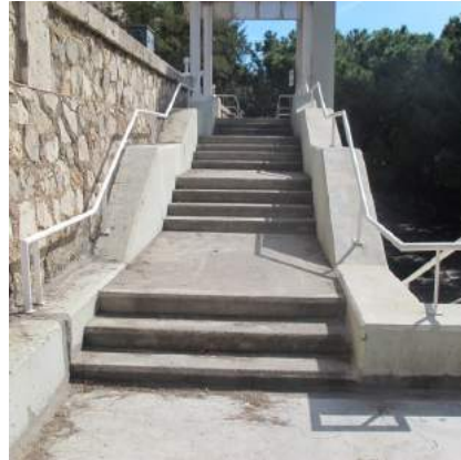
Falta de pavimento señalizador en el desembarque
