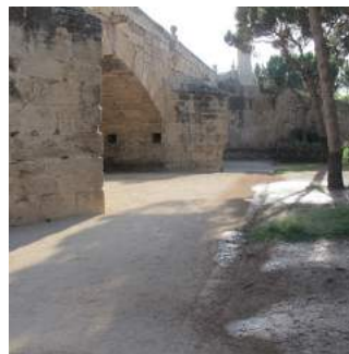
Falta de bordillo delimitador
