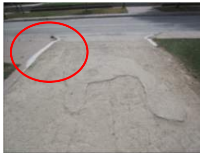
16 Falta de mantenimiento revestimiento de bordes
