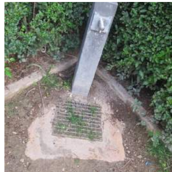
Rejilla cubierta de arena
