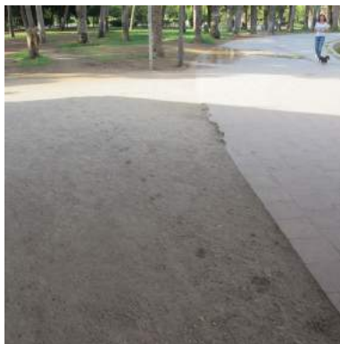
Falta de continuidad del pavimento por la utilización de dos tipos diferentes.
