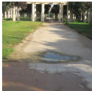
Acumulación de agua
