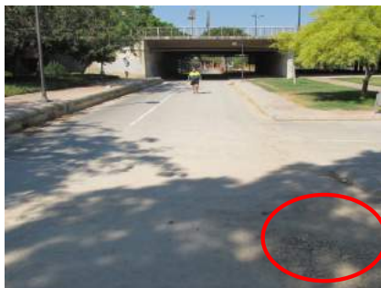
26 Pavimento disgregado que precisa mantenimiento
