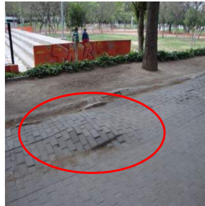
Falta de mantenimiento del IT04
