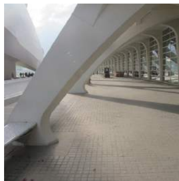
Pilares que invaden la altura libre de 3,00m
