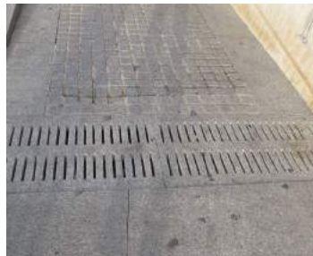
Rejilla de recogida de agua
