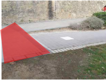
Falta de pavimento señalizador en el cruce con el carril bici
