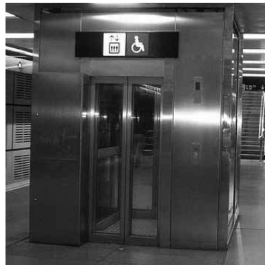
Puerta transparente en ascensor de Metro 53
