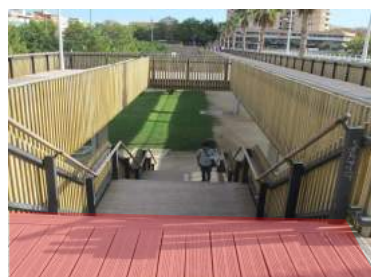
Falta de pavimento en el desembarque
