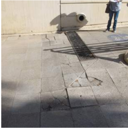
Falta de mantenimiento en el pavimento
