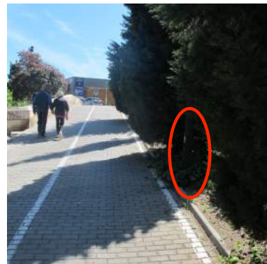
farola instalada en la zona intermedia de la rampa
