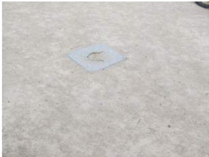
Tapa de registro dañada
