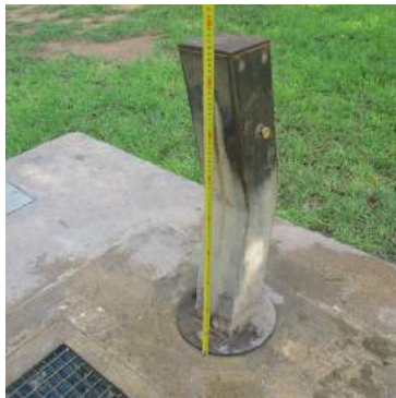
Toma de medida con el metro para conocer la altura del caño de la fuente.
