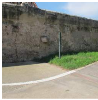
Falta de mantenimiento del cartel
