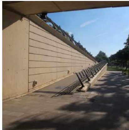
Carencia de pavimento señalizador al final de la rampa
