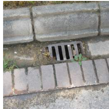
Rejilla de recogida de agua
