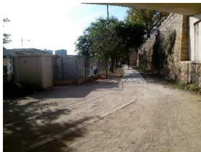
Falta de mantenimiento del pavimento de arena morterenga
