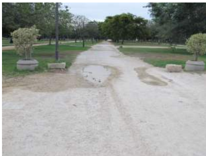
Pavimento dañado en inicio
