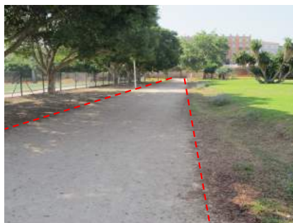
51 Falta de bordillo delimitador zonas ajardinadas
