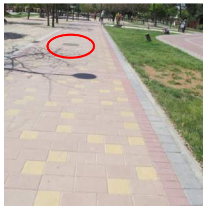
Trapas de instalaciones en el itinerario peatonal
