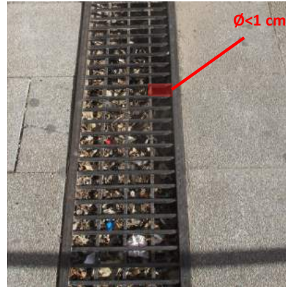
rejilla de acceso al cauce
