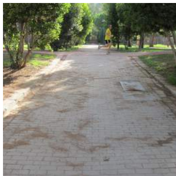
Falta de mantenimiento de limpieza
