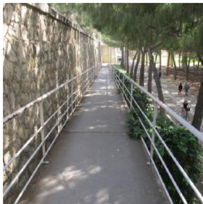
Ausencia de mesetas intermedias cada 9,00 metros
