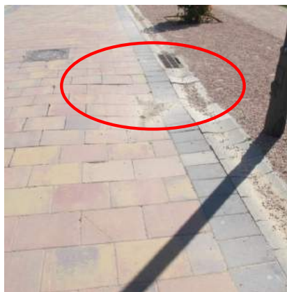
Hundimiento de baldosa hidráulica
