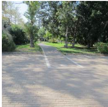
Inicio de la disgregación del carril bici
