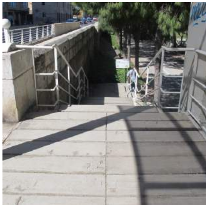
Falta de pavimento táctil indicador de advertencia en el embarque desde el vial superior
