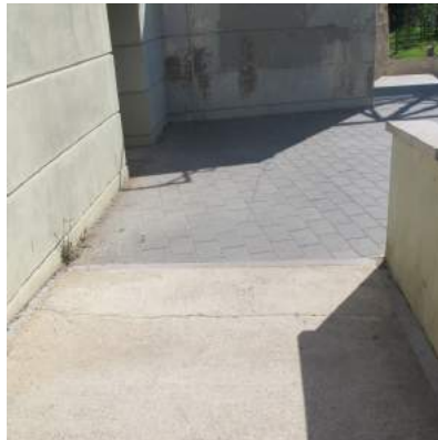
carencia pavimento señalizador al final de la rampa
