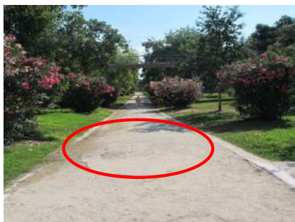
13 Resaltes por erosión del pavimento
