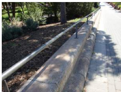
Detalle de la protección lateral
