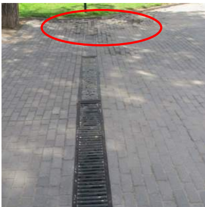
falta de mantenimiento del pavimento
