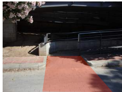
Falta pavimento señalizador en desembarco
