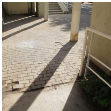
Falta de pavimento señalizador al final de la rampa
