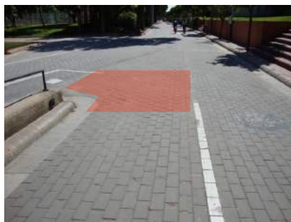
Falta de pavimento señalizador
