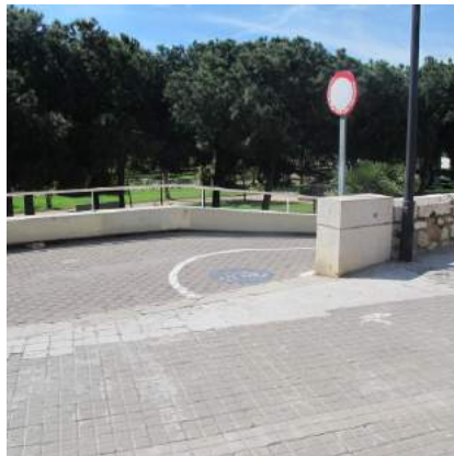
Acceso sin franja de pavimento señalizador de 1,20 metros de ancho
