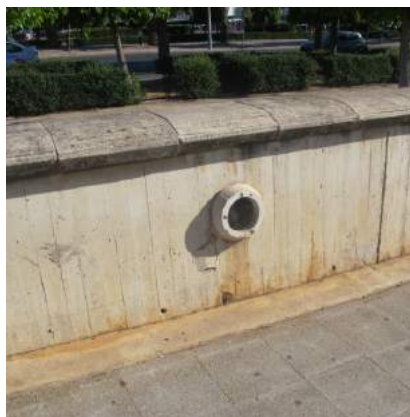
carencia de mantenimiento de iluminación tipo ojo de buey
