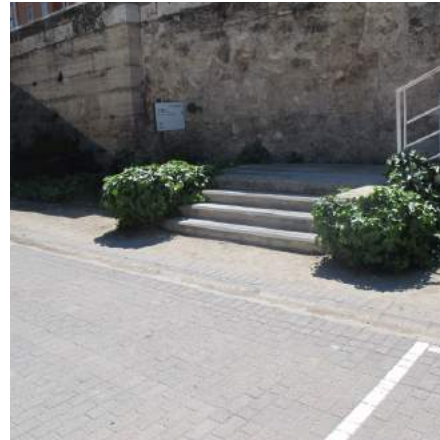
Falta de franja de 1,20 metros de ancho de pavimento táctil indicador
