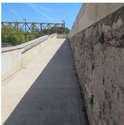
Falta coronación del muro y pasamanos
