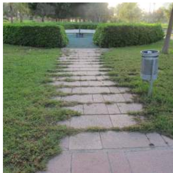
Vegetación entre las juntas del pavimento
