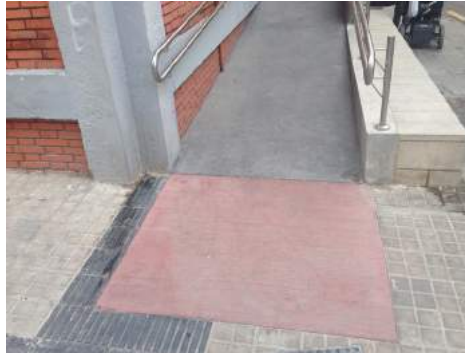
Pavimento táctil señalizador
