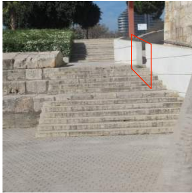
Falta de continuidad muro de antepecho
