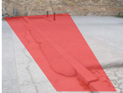
Eliminación del desnivel creado para la retención de agua.
