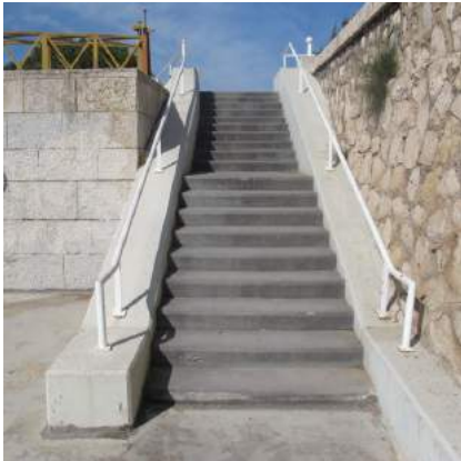
Falta de pavimento señalizador en el desembarque
