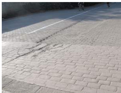
Falta de mantenimiento en el pavimento
