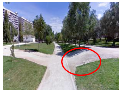
34 pavimento disgregado en cambio de rasante
