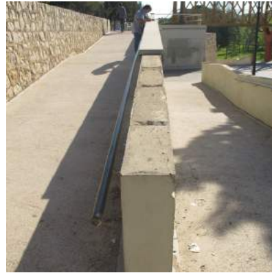
Falta de coronación muro rampa
