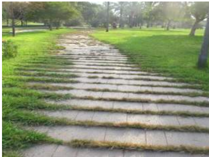
Vegetación invadiendo el itinerario peatonal
