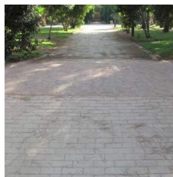
Falta de pavimento señalizador cuando cruza el carril running
