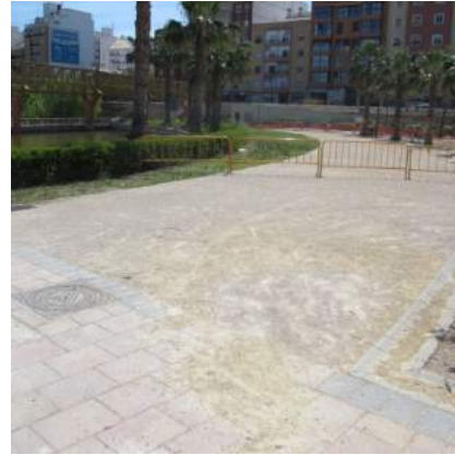
Presencia de grava suelta en el itinerario peatonal
