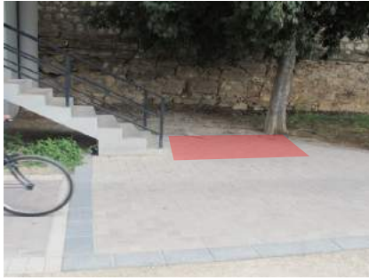
Falta de franja de pavimento de advertencia
