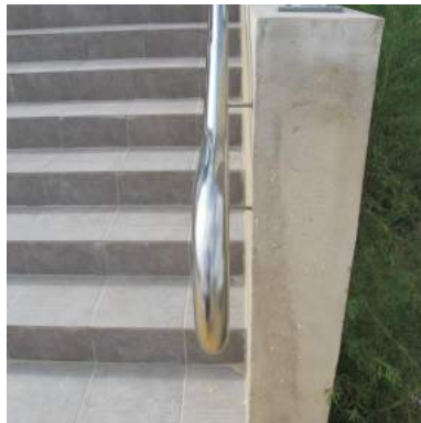
Separación con el pavimento superior a 4 cm
