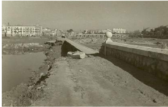
Dstrucción del petril de la ribera izquierda río arriba, entre los puentes de Seranos y San José (al fondo) a causa de la riada de 1957 25 .
