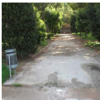
Acumulación de agua
