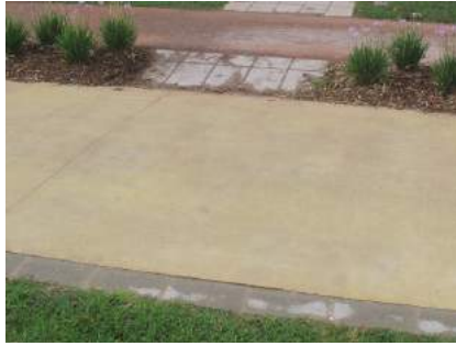
Solera de hormigón rayada
