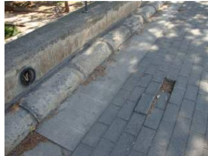
Falta de mantenimiento en pavimentación e iluminación
