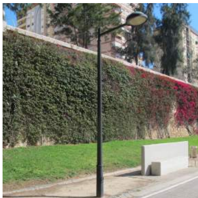
luminaria que encontramos en todo el tramo 1-2
