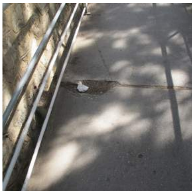
Existencia de grietas por falta de mantenimiento
