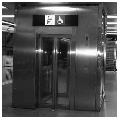
Puerta transparente en ascensor de Metro 53
