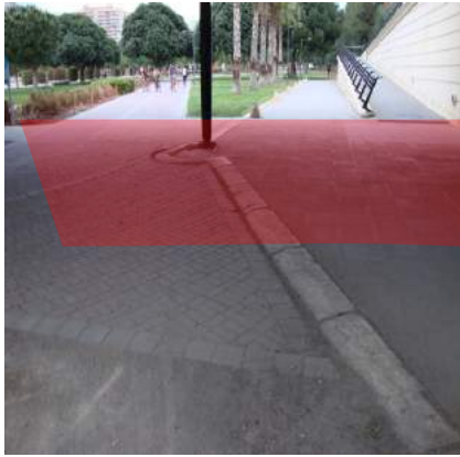
Falta de pavimento de advertencia al cruzar el carril bici
