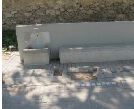
Pavimento en mal estado para acceso a la fuente tipo 4
