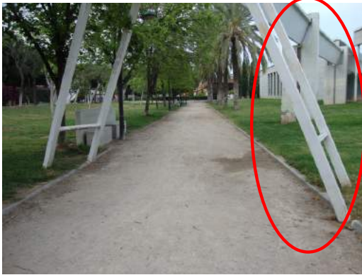
No cumple con la altura libre de 3,00 metros
