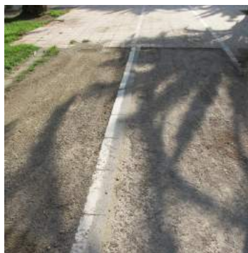
mala compactación del solado
