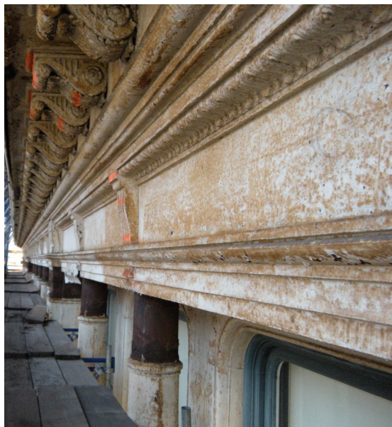
Figura 5.2.8: Fotografía de detalle de una fachada de fundición en un edificio de Broadway, New York. Fotografía: Marie Ennis (2010)
