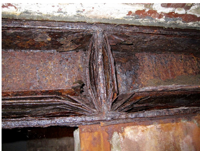
Figura 5.7.4: Oxidación severa en una viga de acero. Fotografía del autor.
