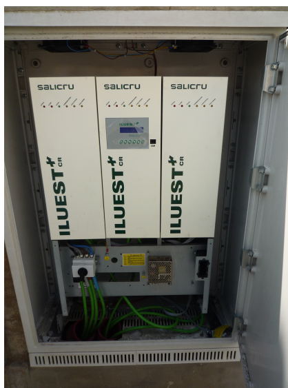
Sistema de regulació de flux en el quadre de comandament
