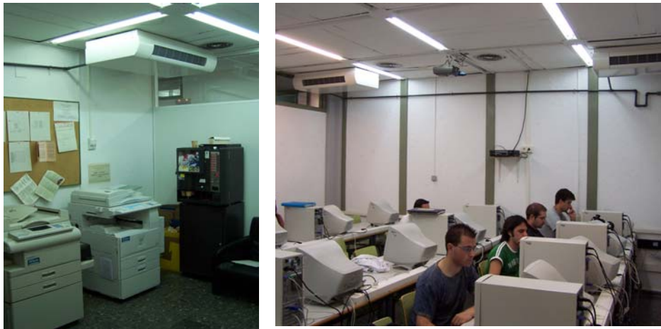
Figura 3.21 Unidades interiores instaladas en el Departamento de Termodinámica Aplicada
