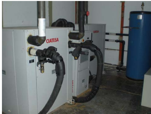
Figura 3.18 Sala de máquinas de la instalación GeoCool
