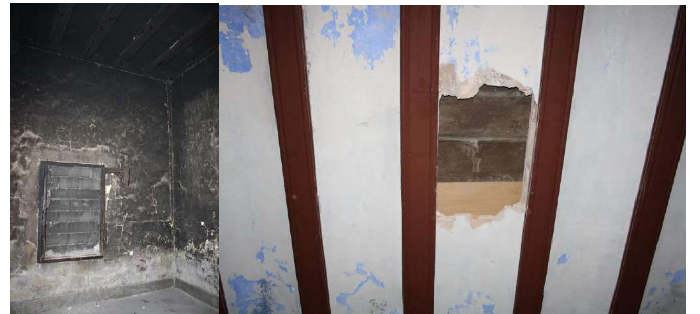
Fig. 43. Habitación quemada en planta Baja. Hueco en forjado. Fuente: Propia
